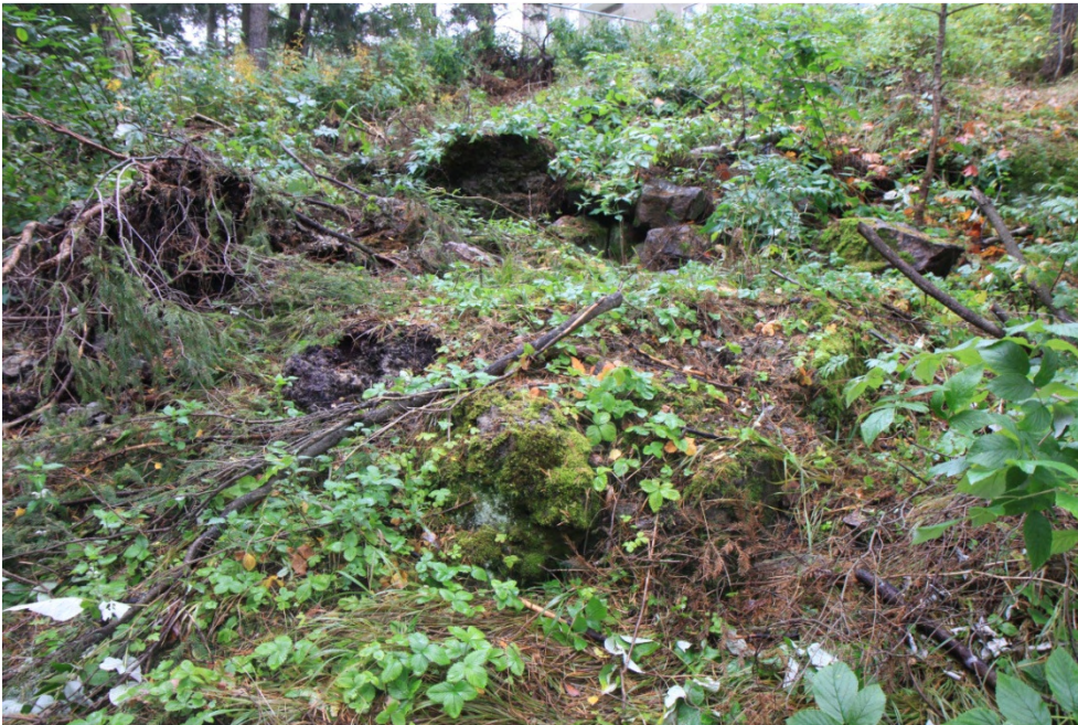
DG2709:7. Tuhottu ja peitettetty suojahuone. Etualalla seiniä, taustan rinteessä jäänne suojahuoneen noin 1 metrin paksuisesta katosta. Kaakkoon. Kuvaaja Mikko Suha.
