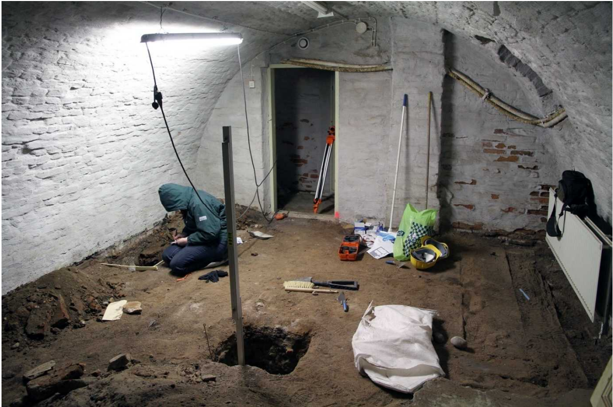
Edessä on koekuoppa 5 ja seinän vieressä koekuoppa 6. Oikealla patterin edessä erottuu selvästi lattian hirret. Uusi ovi tuli koekuoppa 6:n kohdalle.
