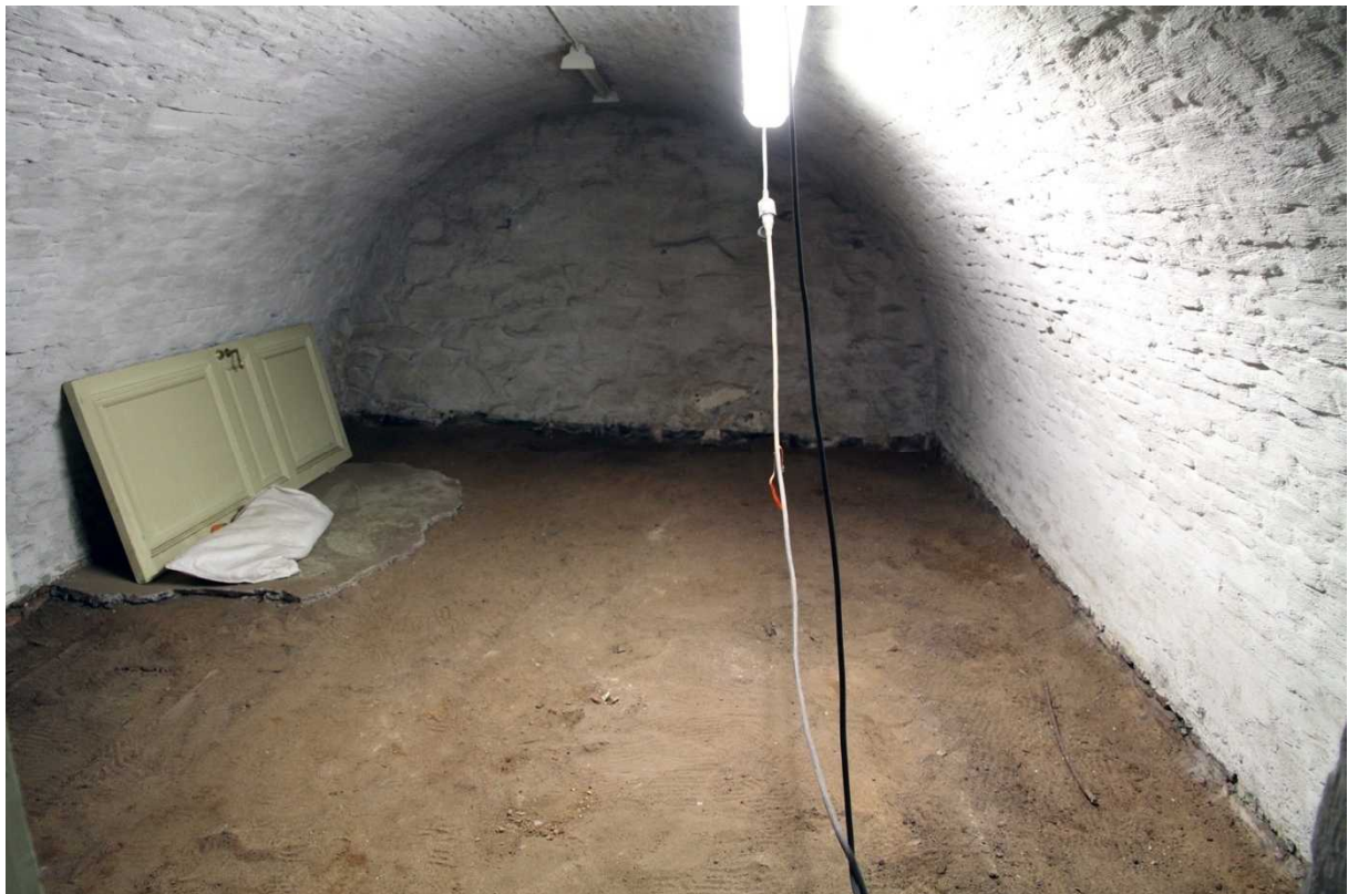
Sunn S017:n kellaritila betonilattian poiston jälkeen. Itäseinän äärellä näkyy betonilattian jäännös, jonka alla ei näy tiililattiaa. Seinien vieressä näkyy heikosti seinien suuntaiset hirret.
