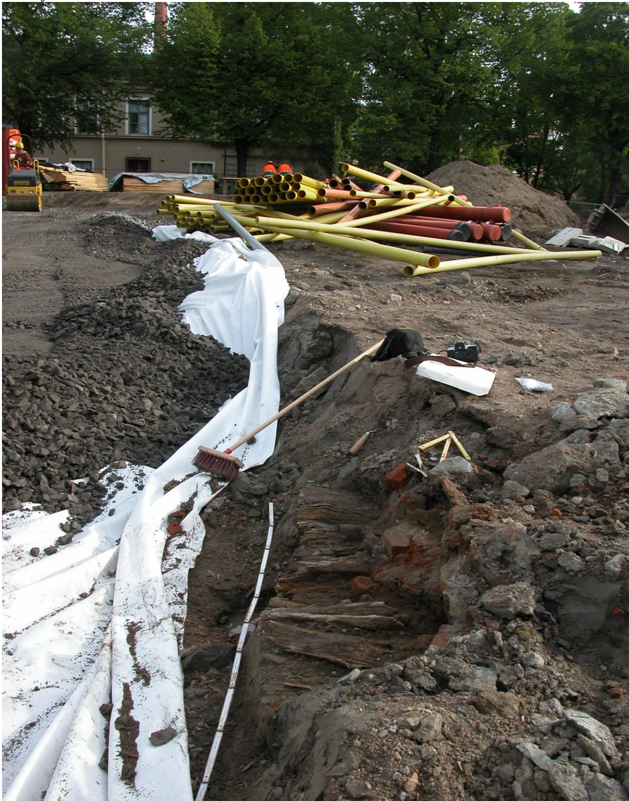
Kuva 4: Yleiskuva A-alueesta, etualalla rakenne A2. Taustalla Konttoritalo Puutarhakadun pohjoispuolella. Kuvattu pohjoisluoteeseen. Kuvaaja Sami Raninen.
