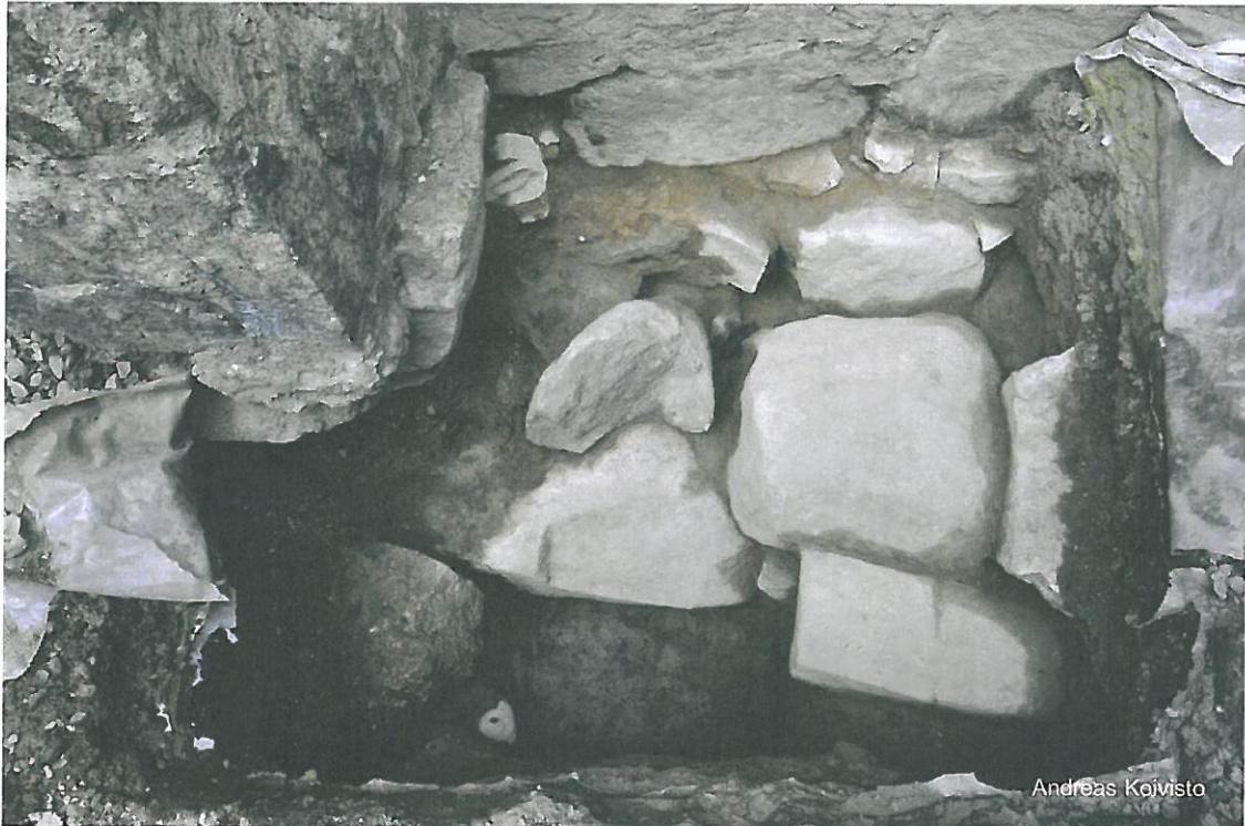
Kuva 9. Myös koekuopan 4 kohdalla kirkon eteläseinän eteen oli kasattu suuria kiviä. Kuvassa vasemmalla näkyvän tukipilarin alta nähti irronneen kivi.
