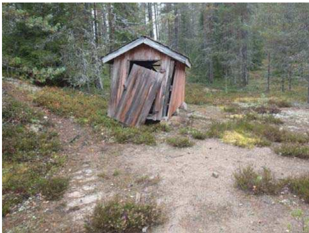
”Konehuone” kuvattu etelästä.
