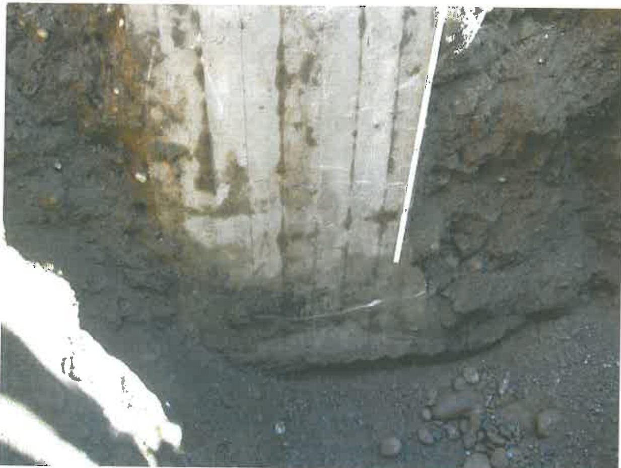
Kuva 7. Koekairauspisteen 7 koekuopassa havaitun itäisen betonirakenteen alaosa. Kuvaaja: Sami Raninen.
