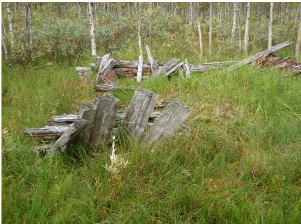
Kuva 153. Kurtakko. Niittyladon jäännökset. Niittyladon etuseinän romahtaneita rakenteita. Kuvattu etelälounaasta.
