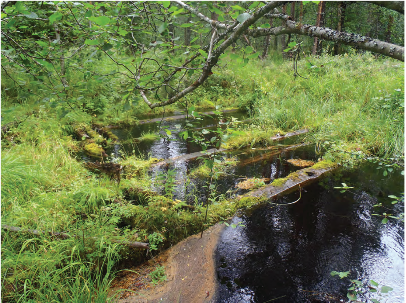
Aittojoen Alakosken silta oli veden alla kesällä 2012. P8050109.jpg.
