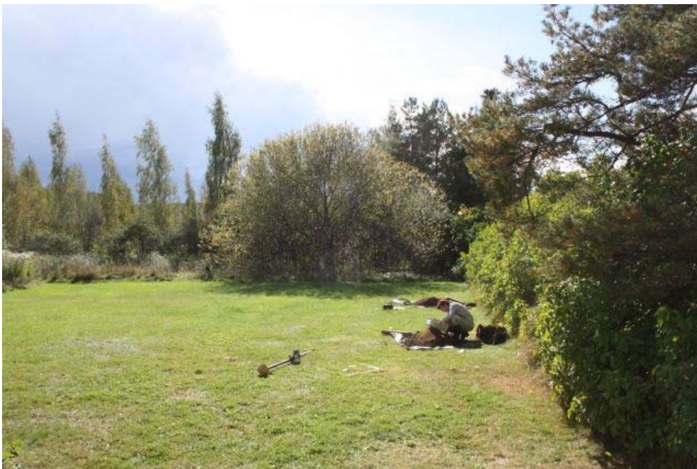
DG2962:4. Koekuop- pien kaivuuta Pappi- lan puutarhaan vie- märilinan kohdalle. Pohjoisesta. Kuvaaja: Petro Pesonen.
