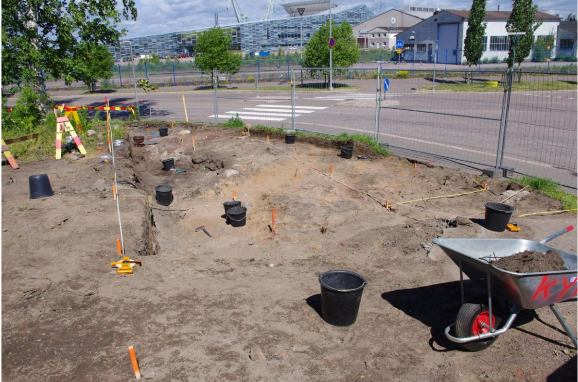
Kuva 12: NE-laajennuksen alueen tutkimukset alkuvaiheessaan paalutuksen ja aloitustason siistimisen jälkeen. SE. Kuva: KyM/M. Kykyri.
