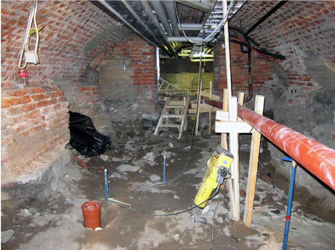
Kuva 45. Kellari 0033. Kellaritila on tyhjennetty kokonaan ja perustusten vahvistamiskokeita on meneillään. Kuvaussuunta W. 18.8.2011.
