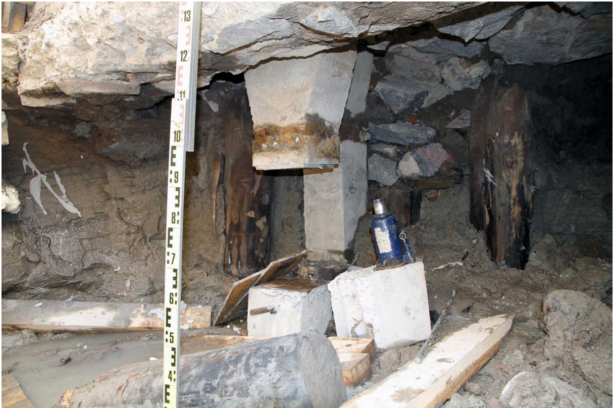
Kuva 91. Etupiha. Vanhan kiviperustuksen alla näkyi pystypaaluja ja megapaaluja, joista yksi on katkaistu koeponnistusta varten. Kuvaussuunta NW. 4.10.2010.
