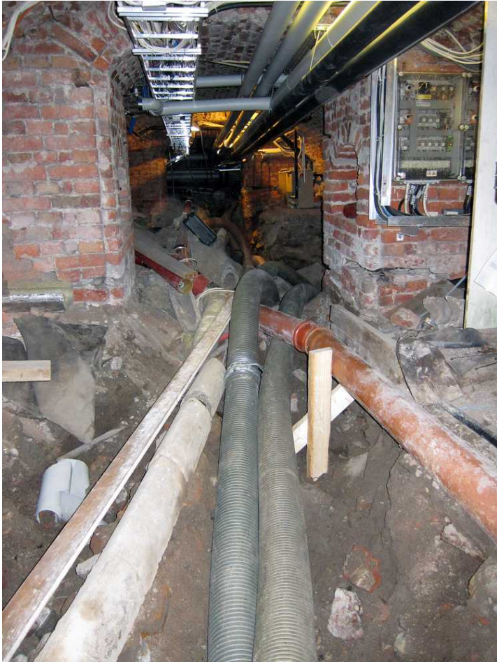
Kuva 21. Kellari 0034. Kellaritilan itäosa. Harmaat putket vasemmalla betonisuojiin alla olevien kaapeleiden ja oikealla olevan ruskean muoviputken välissä ovat imuriautoista tulevia letkuja. Niiden avulla imettiin hiekkoja pois kellarista. Taustalla näkyy kellaritila 0032. Kuvaussuunta E. 28.6.2011.
