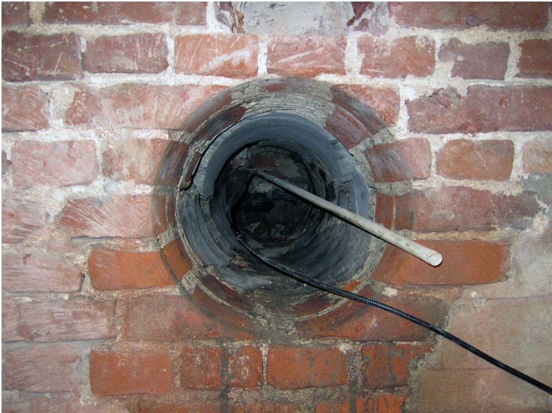
Kuva 66. Kellari 0002. Kellaritilan itäseinään porattu reikä, jolla selvitetiin linnan pääsisäänkäynnin alapuolisen tilan luonnetta. Kuvaussuunta E. 18.8.2011.
