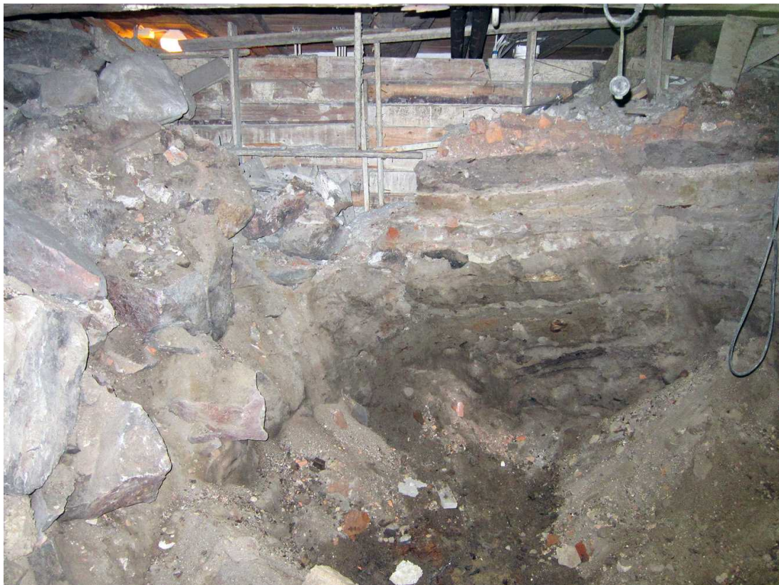
Kuva 180. Kellari 0007, tila B. Vasemmalla on tilojen B ja C välinen poikittainen kiviperustus. Tilan B itäpuolisko on tyhjennetty kokonaan ja länsipuolisko pitkittäisen lattiavasauksen länsipuolella melkein läntisen putkitunnelin seinään saakka. Seinän edessä on vielä ohuelti maakerrokset paikoillaan. Kuvassa on maaleikkauksen eteläosa. Kuvaussuunta W. 26.8.2011.
