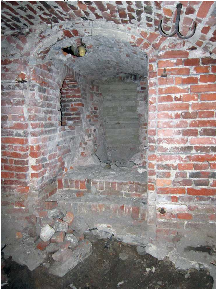
Kuva 10. Kellari 0033. Itäinen tila, joka ei johtanut mihinkään. Sen paksu tiilinen itäseinä oli rikottu ja paikalla oli megapaalun yläpuolinen betoniosuus. Oikealla ylhäällä näkyy ripustuskoukku. Kuvaussuunta NEE. 18.8.2011.
