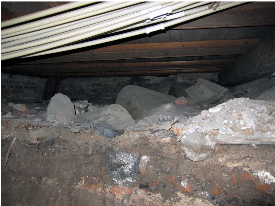
Kuva 188. Kellari 0007, tila C. Maakerrosten ja lattian välinen tyhjä tila tilassa C. Kuvaussuunta S. 26.8.2011.
