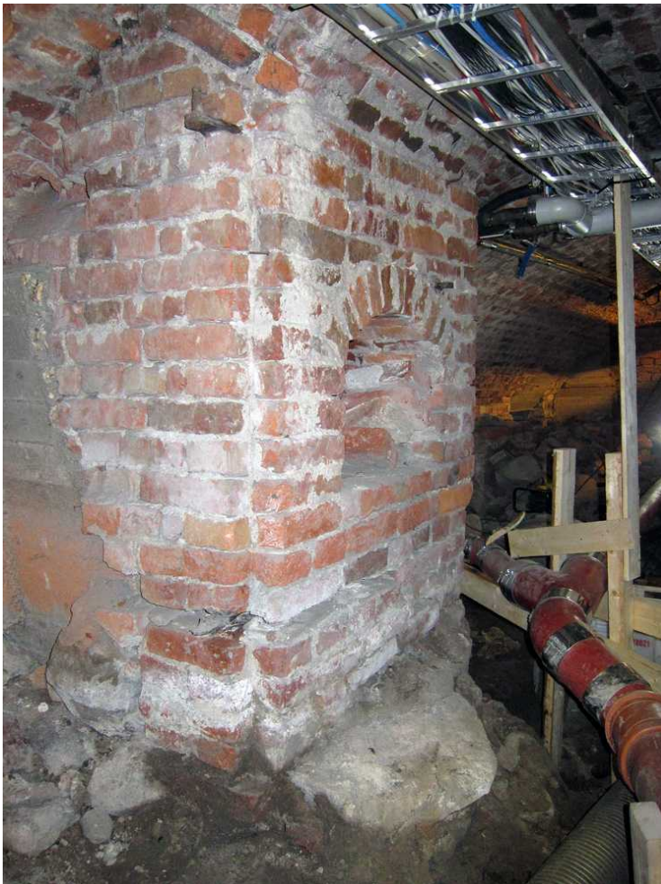
Kuva 26. Kellari 0034. Kellaritilojen 0034 ja 0032 välinen pohjoinen seinä, joka on revennyt alaosastaan. Oven kulmakolon vieressä näkyy oven saranatapit niin ylhäällä kuin alhaalla. Kuvaussuunta NE. 7.7.2011.
