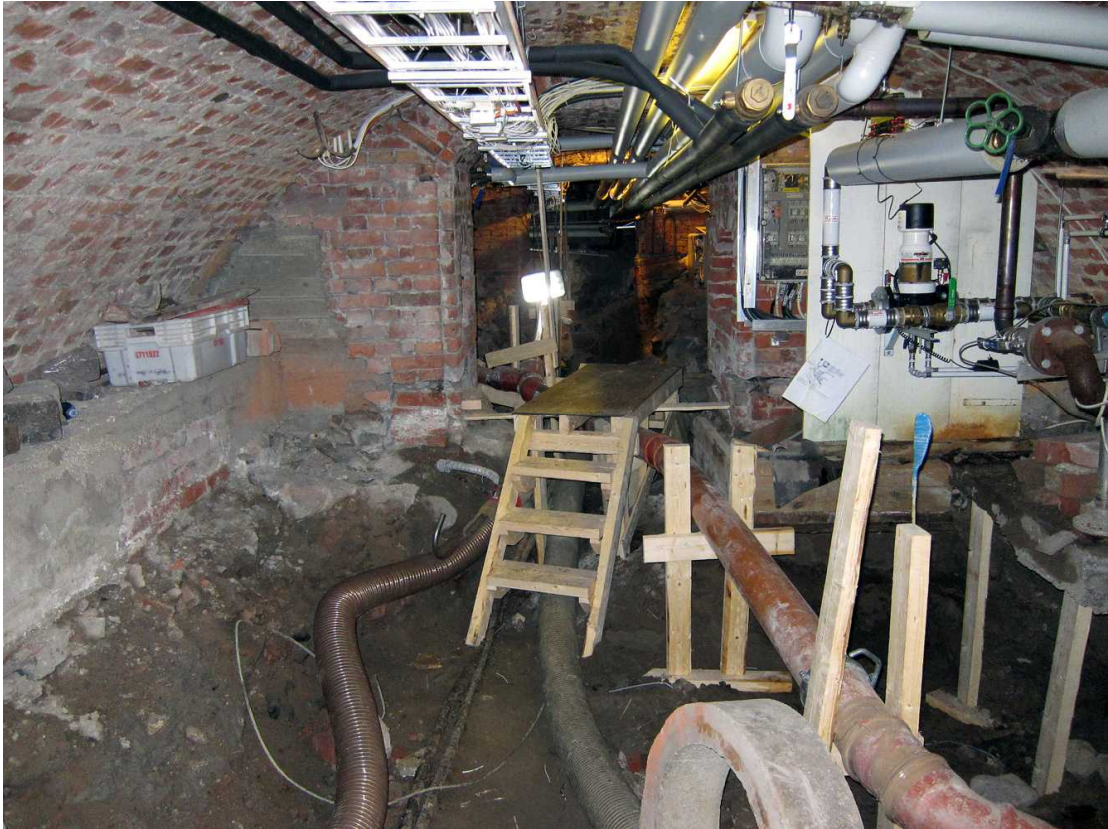
Kuva 23. Kellari 0034. Edellinen kohta. Putkien yli on rakennettu kulkusiltaja. Kuvaussuunta E. 4.7.2011.
