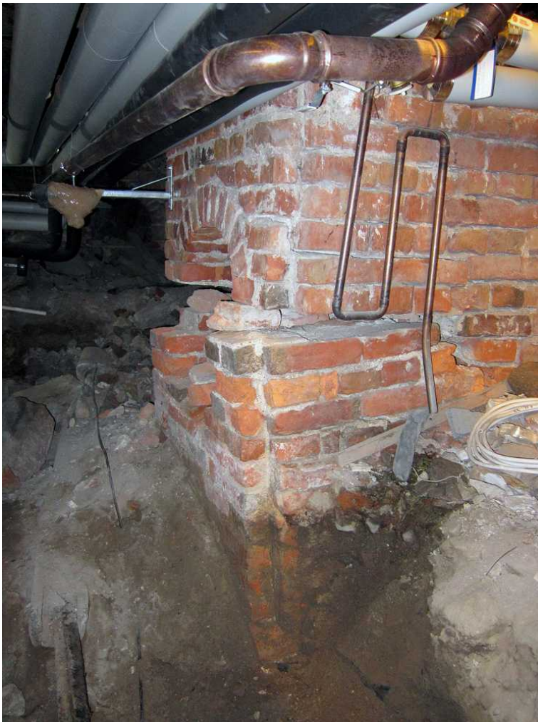
Kuva 42. Kellari 0032. Kellaritilojen 0032 ja 0031 välinen eteläinen seinä, joka on revennyt keskiosastaan. Kuvaussuunta SEE. 30.6.2011.
