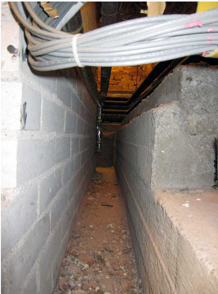
Kuva 68. Kellari 0006. Vasemmalla kellaritilan uuden pohjoisseinän ja vanhan pohjoisseinän uuden betoniperustuksen välinen tila. Oikealla on kellaritilaan 0008 vievän putkitunnelin aukko. Kuvaussuunta W. 28.6.2011.
