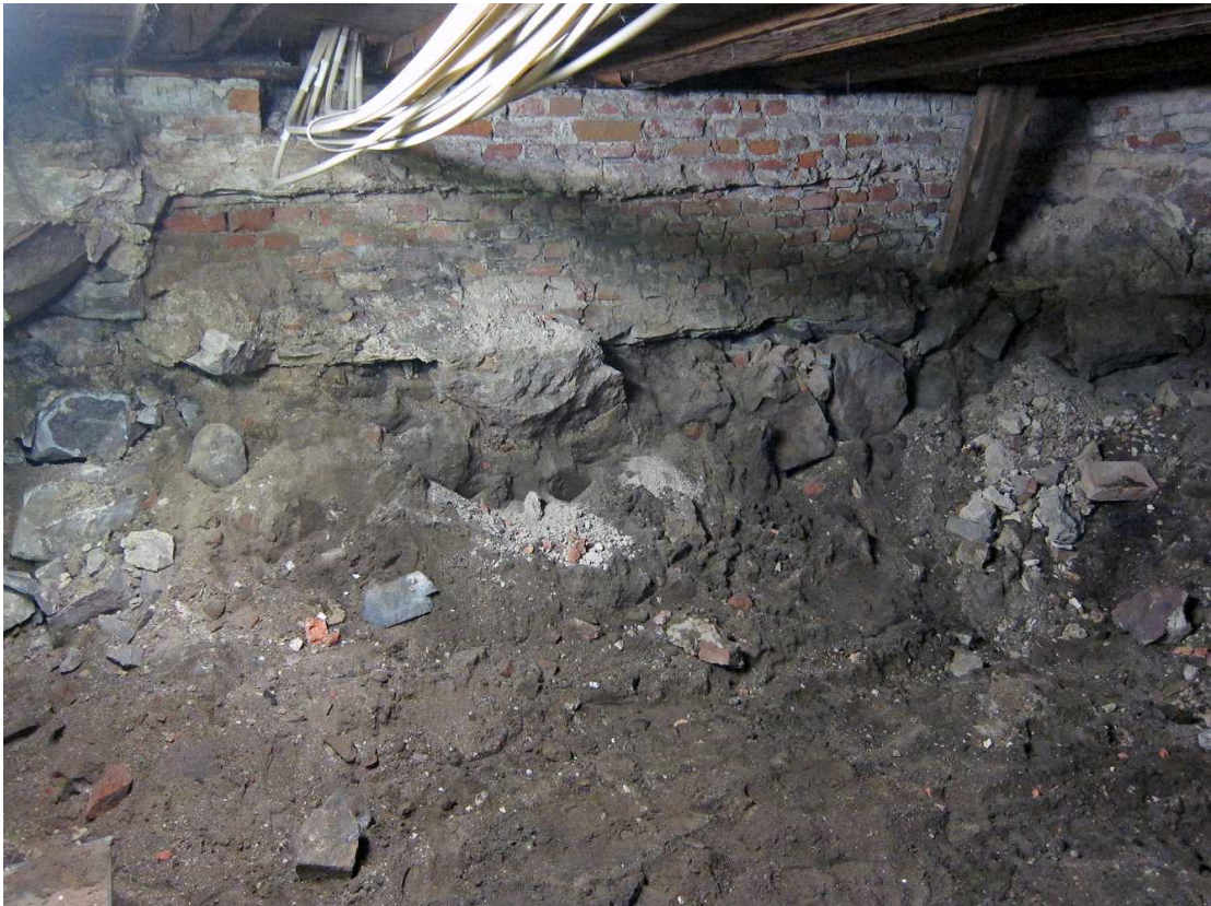
Kuva 204. Kellari 0007, tila C. Läntisen matalan siiven itäseinän kiviperustus ja yläosastaan tiilimuuri tilassa C. Kuvan vasemmassa reunassa on tilojen B ja C välinen kiviperustus. Kuvaussuunta SEE. 30.8.2011.
