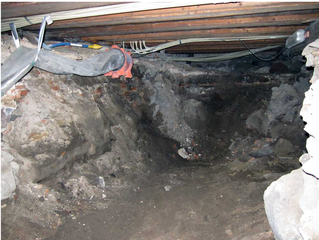
Kuva 182. Kellari 0007, tila C. Tilojen B ja C välinen poikittainen kiviperustus on murrettu tilan perällä. Kuvaussuunta S. 19.8.2011.
