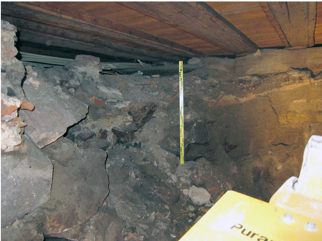
Kuva 136. Kellari 0007, tila A. Kellarin ensimmäisen tyhjentämisalueen eteläseinämä tilan itäpuoliskolla läntisen matalan siiven keskellä sijainneeseen pitkittäisen lattiavaasaan saakka. Tilojen A ja B välinen poikittainen, itä-länsi –suuntainen kiviperustus, on esillä ja jo osittain nyt rikottuna. Kuvaussuunta SW. 16.8.2011.
