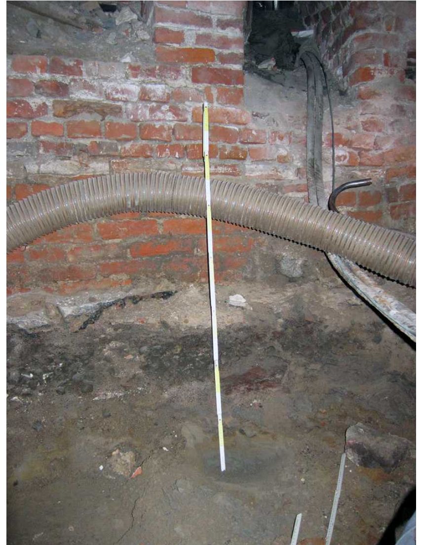
Kuva 54. Kellari 0031. Kellaritilan itäseinän alaosa ja alapuolinen kerros puhtaaseen maahan saakka ( dokumentointikohta 8 ). Tumman pikkukivikerroksen alla pilkottaa puuarina mitan oikealla puolella. Kuvaussuunta E 7.7.2011.
