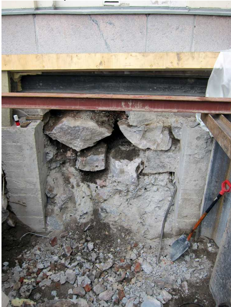
Kuva 124. Etupiha. Lähikuva aukon kohdasta. Vuoden 1960 megapaalutuksen betoniseinän takaa on paljastunut kiviperustus. Kuvaussuunta W. 27.7.2011.
