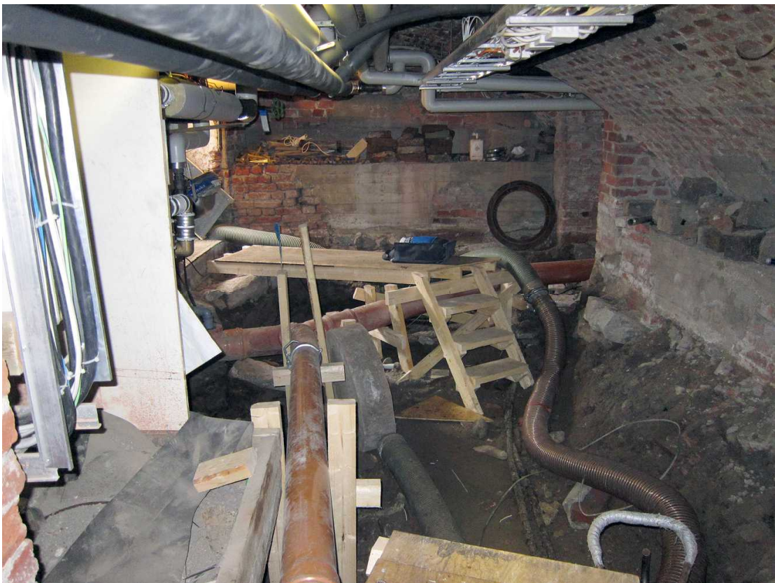
Kuva 24. Kellari 0034. Edellinen tilanne. Kuvassa näkyy pohjois- ja länsiseinän tiilikorokkeet, jotka megapaalujenkin kohdalla on betonoitu samaan muotoon. Kuvaussuunta W. 4.7.2011.
