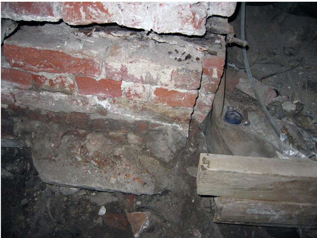
Kuva 28. Kellari 0034. Kellaritilojen 0034 ja 0032 välinen eteläinen seinä, joka on myös revennyt alaosastaan. Repeytymiskohdassa näkyy saranatappi. Kuvaussuunta S. 30.6.2011.
