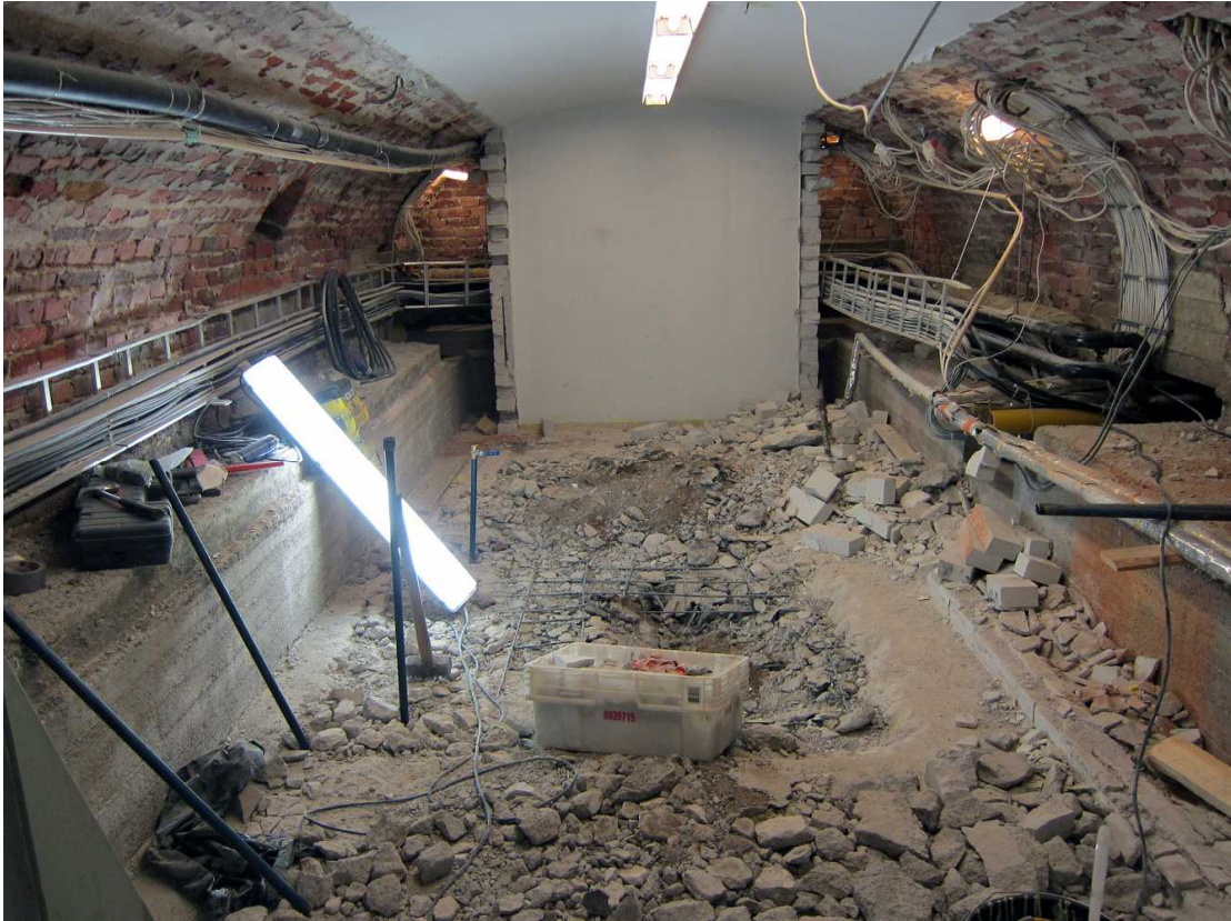
Kuva 73. Kellari 0006. Kellaritilan uudet seinät on purettu suurimmaksi osaksi. Seinien vieressä näkyvät seinien betoniperustusvahvistukset. Lattiaa on avattu ja perustusten vahvistamiskokeet (pystyputket) on aloitettu. Kuvaussuunta W. 27.7.2011.
