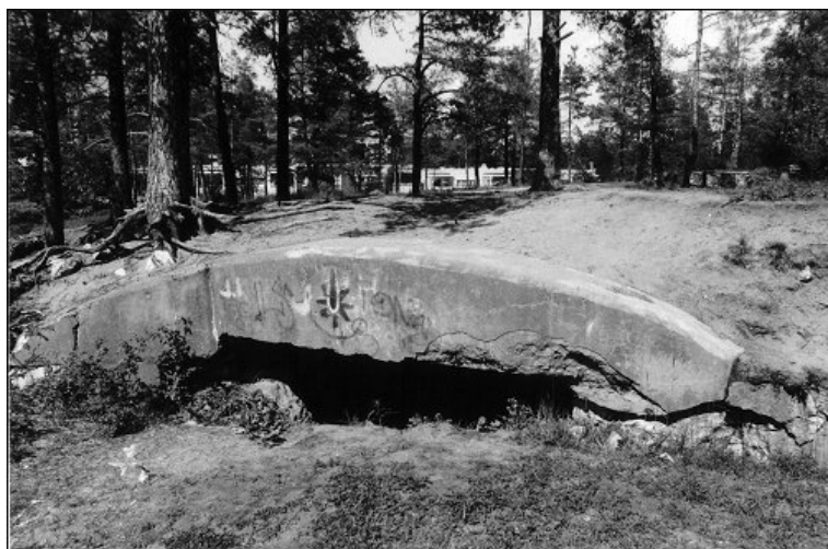
Kuva 14 Suojahuoneen II:8.17 betonikatto on jäänyt ehyeksi vaikka katon teräspalkkisto on räjäytetty pois. Rakenteen päällä olevassa hiekkakerroksessa on eroosioaurio. Kuva MV1:28, John Lagerstedt 2003.
