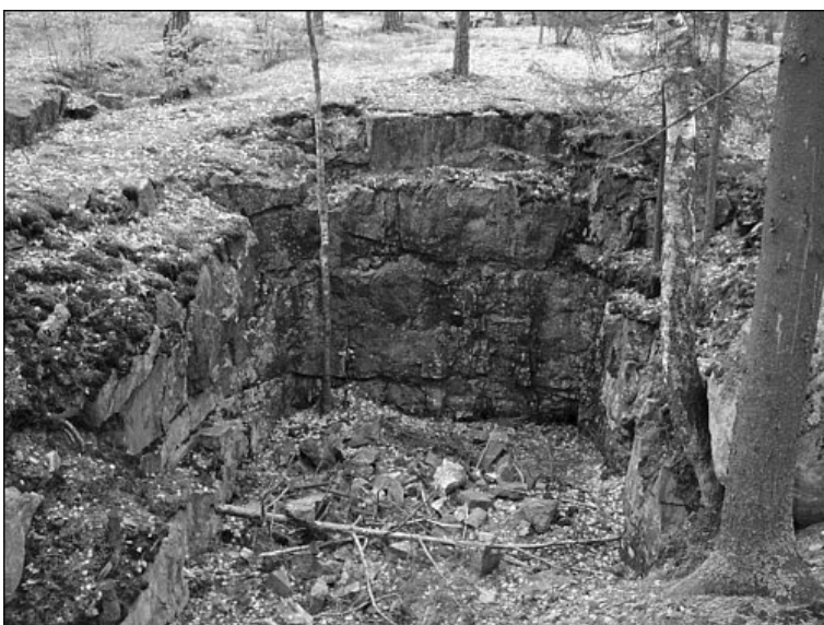
Kuva 22 Kallioon on louhittu kuoppa suojahuonetta varten mutta betonointitöitä ei ole ehditty aloittaa. Kohde II:5.5. Kuva 4834, John Lagerstedt, 2003.
