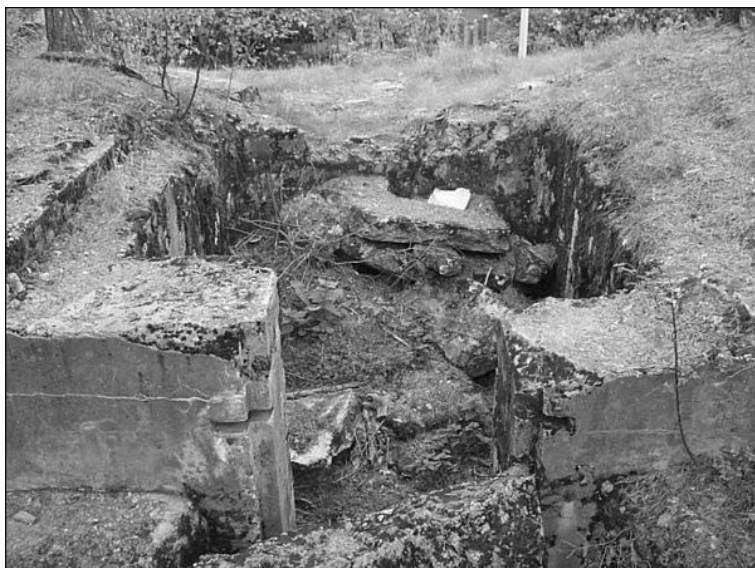
Kuva 4 Konekivääriaseman II:8.6 katto on aikanaan räjäytetty ja asema on täynnä betonilohkareita. Kuva 4630, John Lagerstedt 2003.
