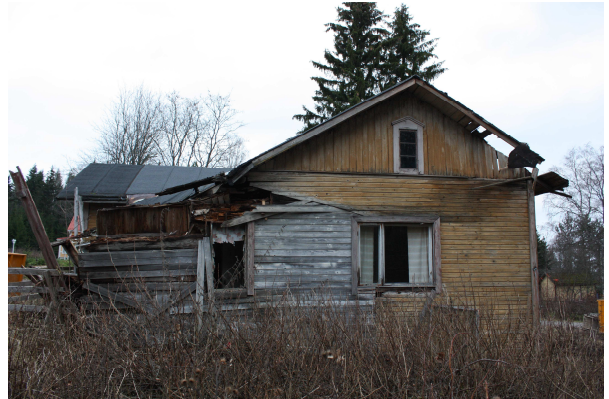
AKDG 3281:4 Purettavana oleva talo, kuvattu etelästä.
