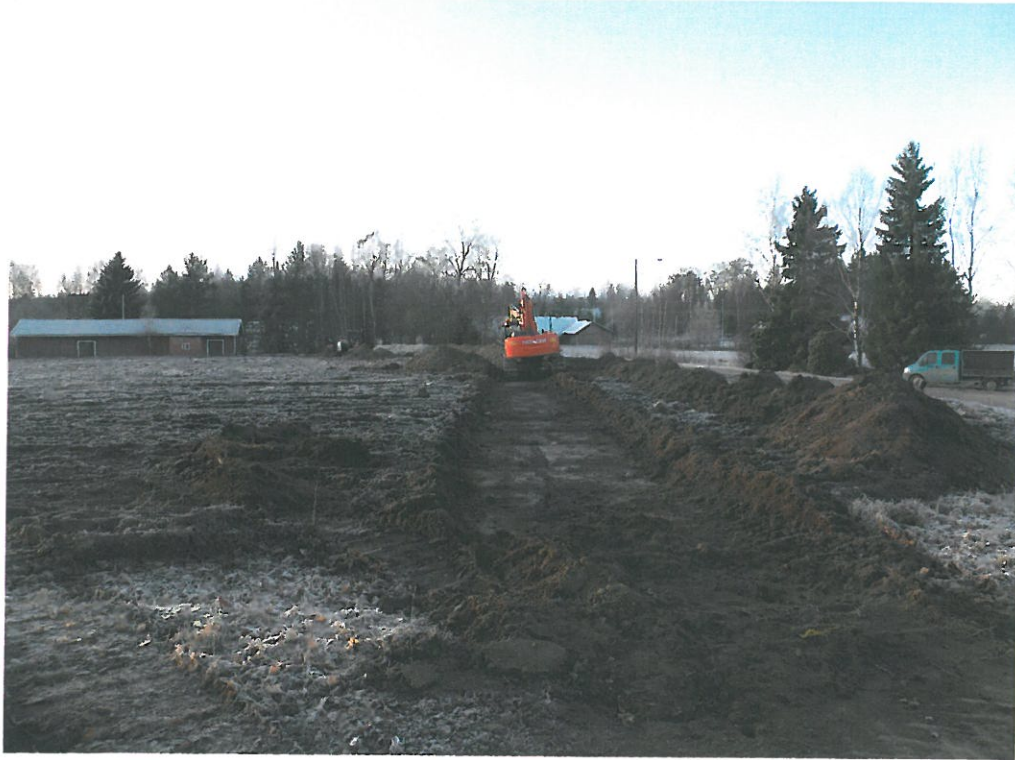
Kuva 1. Vesihuoltolinjaa kaivetaan pellolle Ikaalisten Vatulan kylänpaikalla. Peltomulta on poistettu. KY 27:1 (Kalle Luoto. PMM/KYY).
