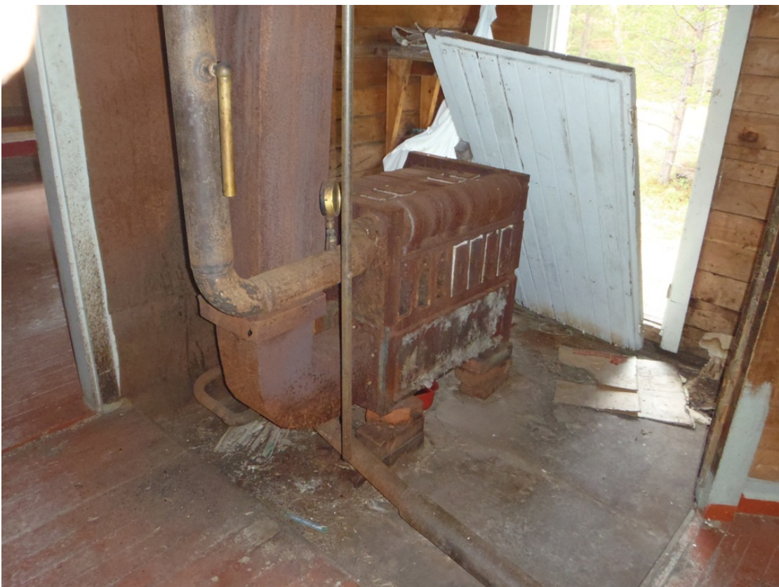
Pääkämpän kuivatushuone on myös pannuhuone. Pohjoisseinän ovi on kaatunut sisään.
