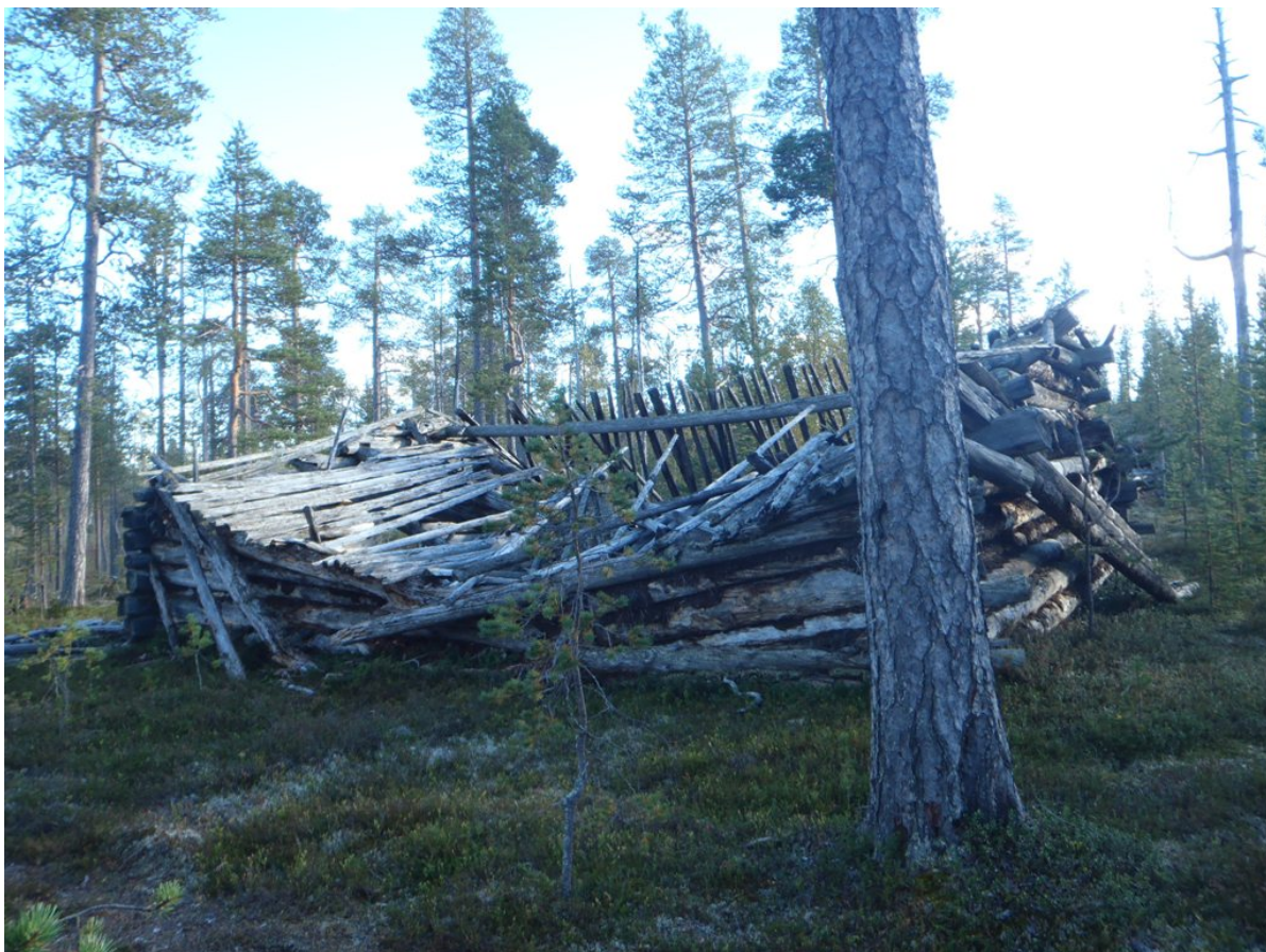
Kämpän katto on romahtanut sisään. Kuva otettu kaakkoon.
