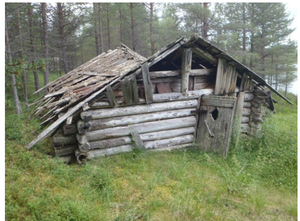
Rakennus 5 on yhä pystyssä, mutta katto on jo todella huonossa kunnossa. Kuva otettu etelään.
