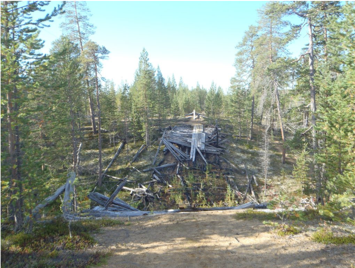
Romahtanut silta kuvattuna länteen.
