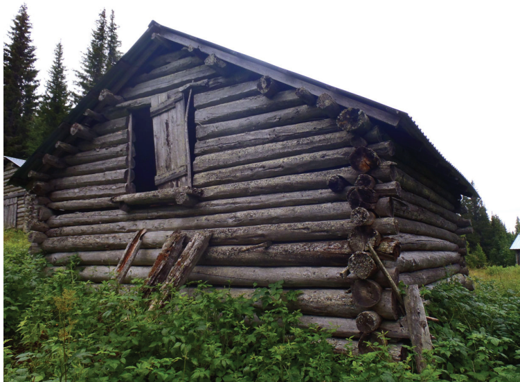
P8090310_edited-1.jpg: Vajarakennukseen oli useita aukkoja. Kuvattu pohjoisesta etelään. Vasemmalla takana hämöttää liiteri.
