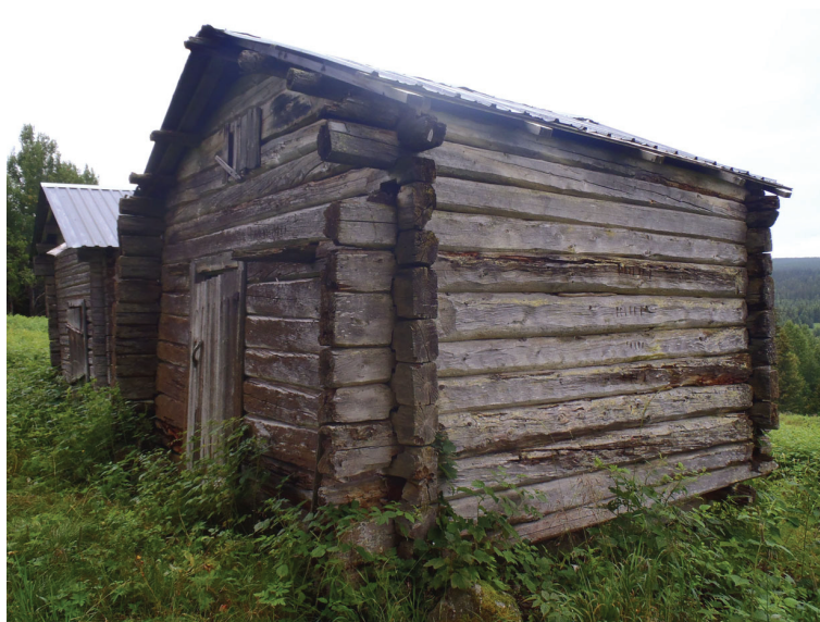
P8090289_edited-1.jpg: Kuvassa näkyy, kuinka aitta lepää luonnonkivisellä jalalla. Alimpana kivien päällä on hirsinen kehikko, joka on itse rakennusta pienempi. Suuremman aitan seinähirret ovat kärsineet.
