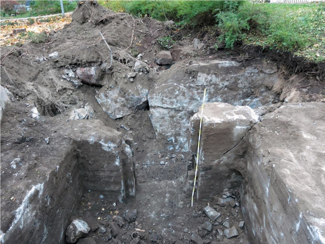
Metallitynnyrin ja ison louhintakiven kohdalla on mennyt todennäköisesti taisteluhauta etelään viereiselle tontille. Sirkku Laineen linnoituskartan mukaan hauta menisi suojahuoneen vieritse kuvasta oikealle erittäin kapeassa haudassa. Kuvaussuunta SE. HKM/Helsinki, Kaarela 2013:29.
