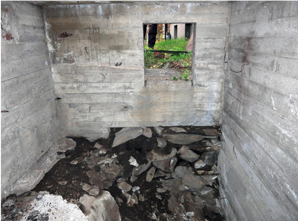
Kuva 58. Valvonta-alueen länsipuolella sijaitsevan tontin rakennuksen lounaisnurkan terassin alla oli maanalainen tila, jota paikalliset asukkaat olettivat linnoitteen osaksi, bunkkeriksi. Rakenne ei ollut linnoitteen osa, vaikka linnoituskartassa talon kaakkoisnurkan kohdalle taisteluhauta on merkitty kulkevaksi. Kuvasuunta NW. 15.10.2013.
