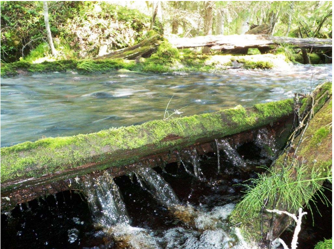
Puron päällä kulkeva lahonnut ja sammaloitunut uittoränni
