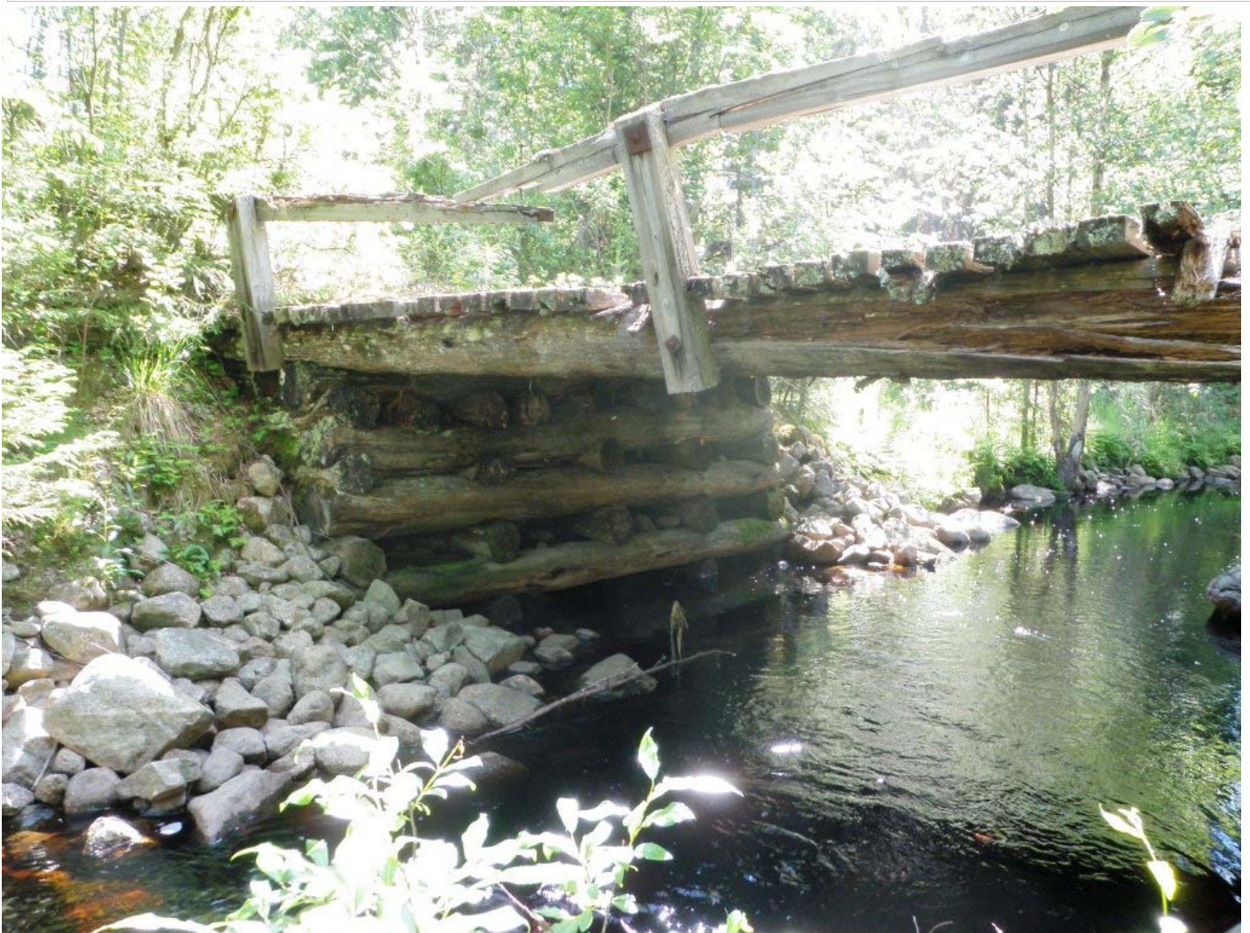
Lahonnut maantiesilta arkkuiheen.
