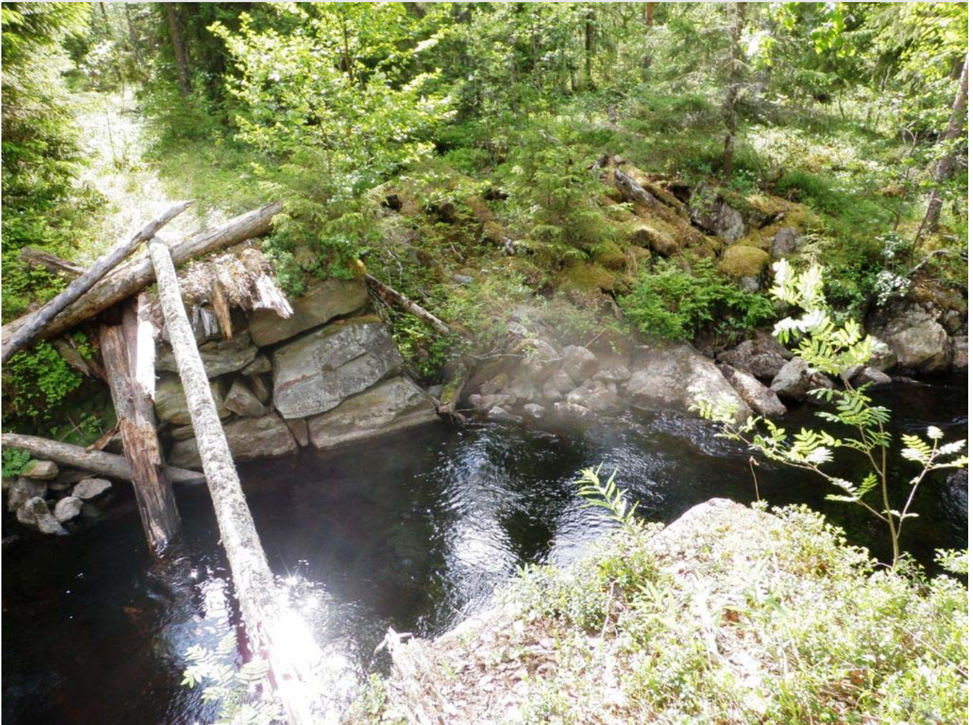
Uittopadon portin rakenteita ja portin päältä kulkeva lahonnut hirsi. Kuvaussuunta länsi.
