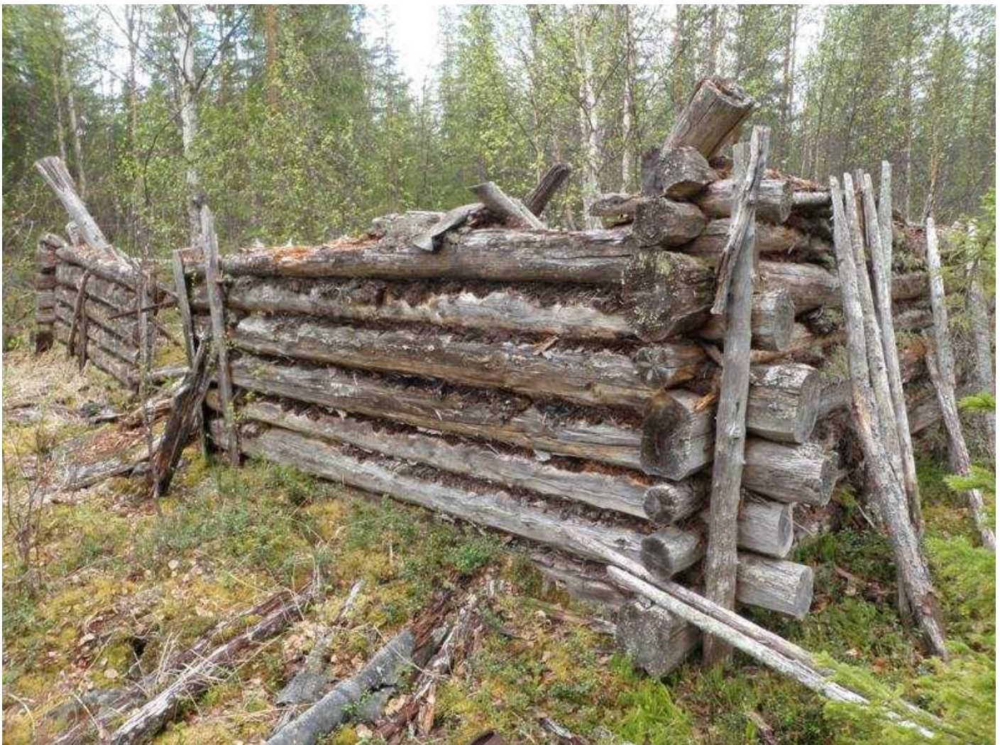
Kämpän seinät ovat vielä pystyssä, katto on romahtanut sisään.
