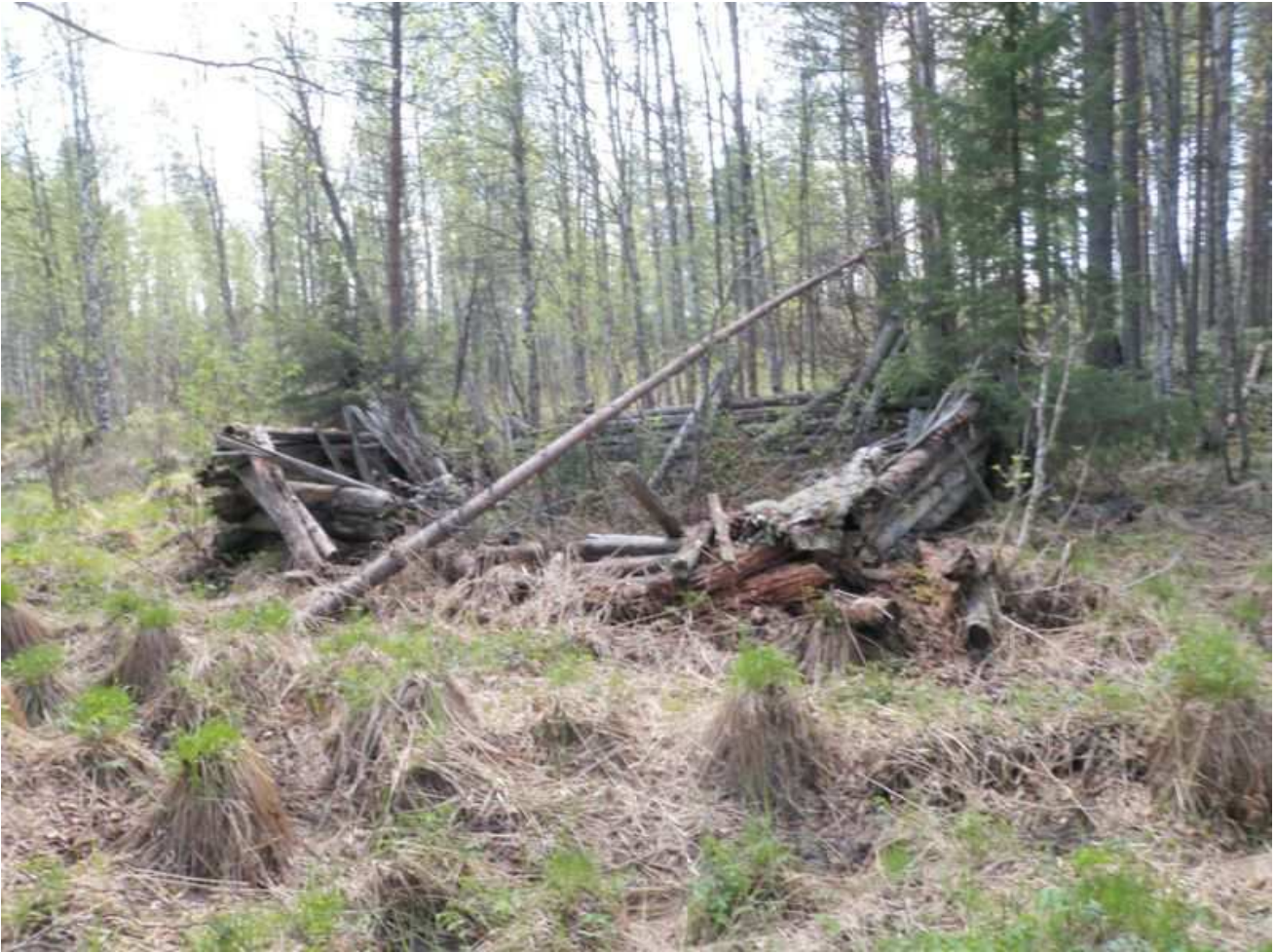
Ladon katto on romahtanut sisään. Kattopuiden päällä on tuohikate.
