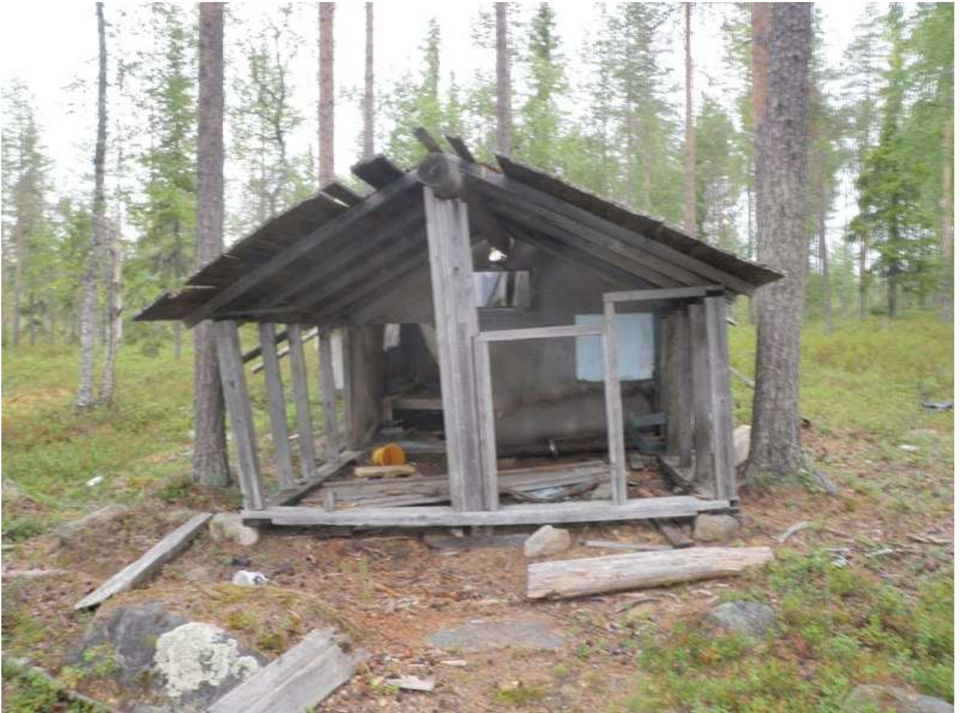
Kalamaja on lautarakenteinen hökkeli. Väliseinä on tehty pahvista.
