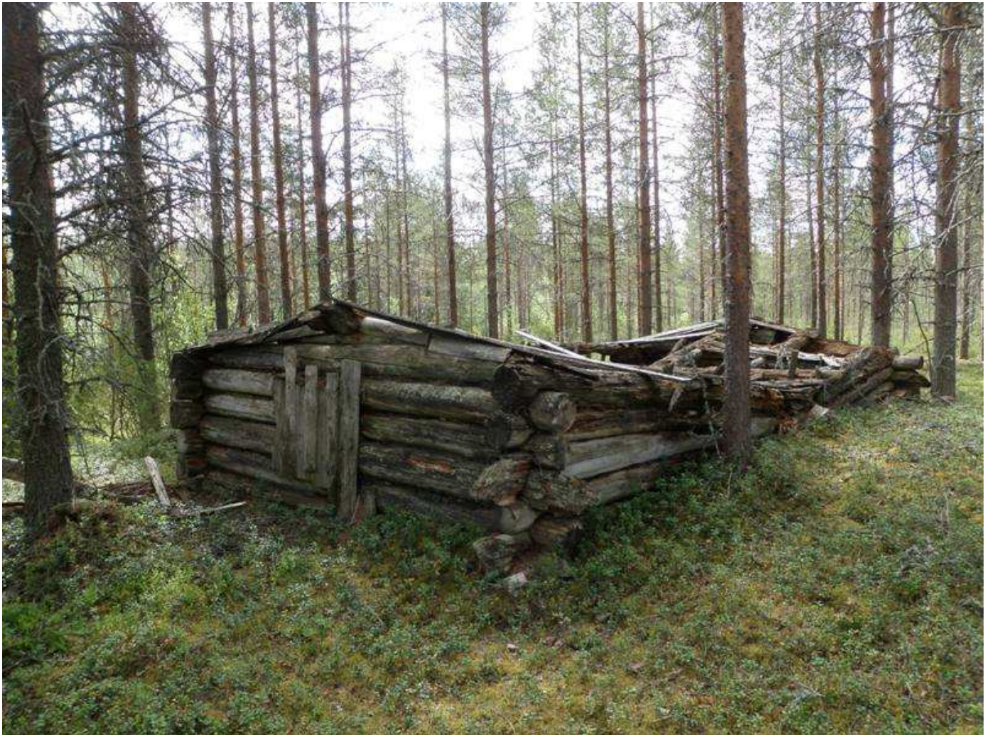
Räkkäsuojan lautakatto on romahtanut. Hirret on katkottu sahalla ja kirveellä.
