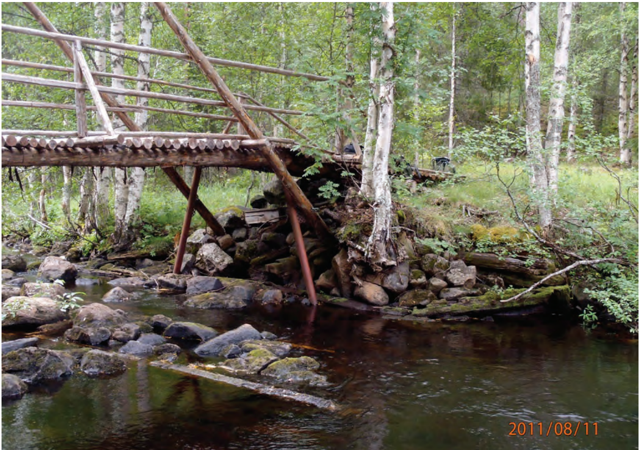
Pahtajoen tammen päälle on rakennettu kevyt silta moottorikelkkareitille. Tammen rakenteet näkyvät hyvin rannoilla ja vedessä. P8110045.
