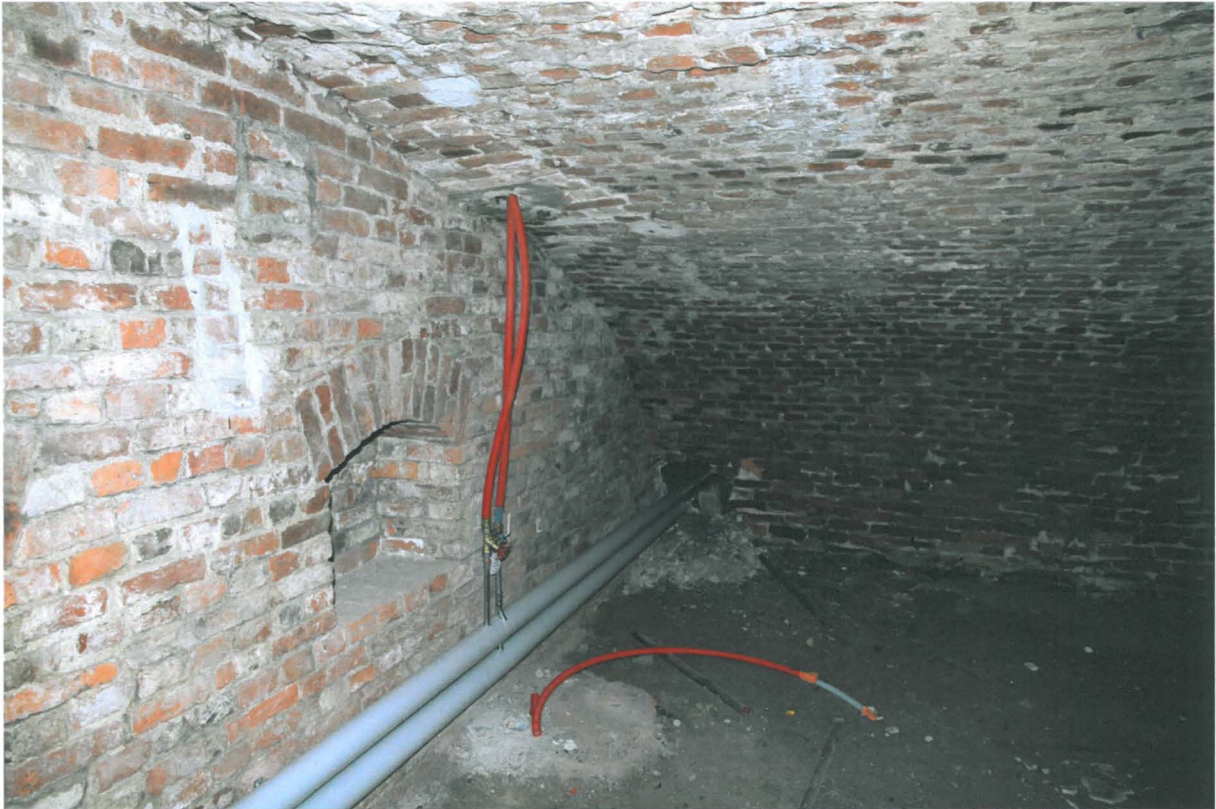
Kuva 55. Sunn S013-014. S014:n eteläseinän läpi oli vedetty putket rikkomalla seinä. Kuvaussuunta SE. 8.11.2010.
