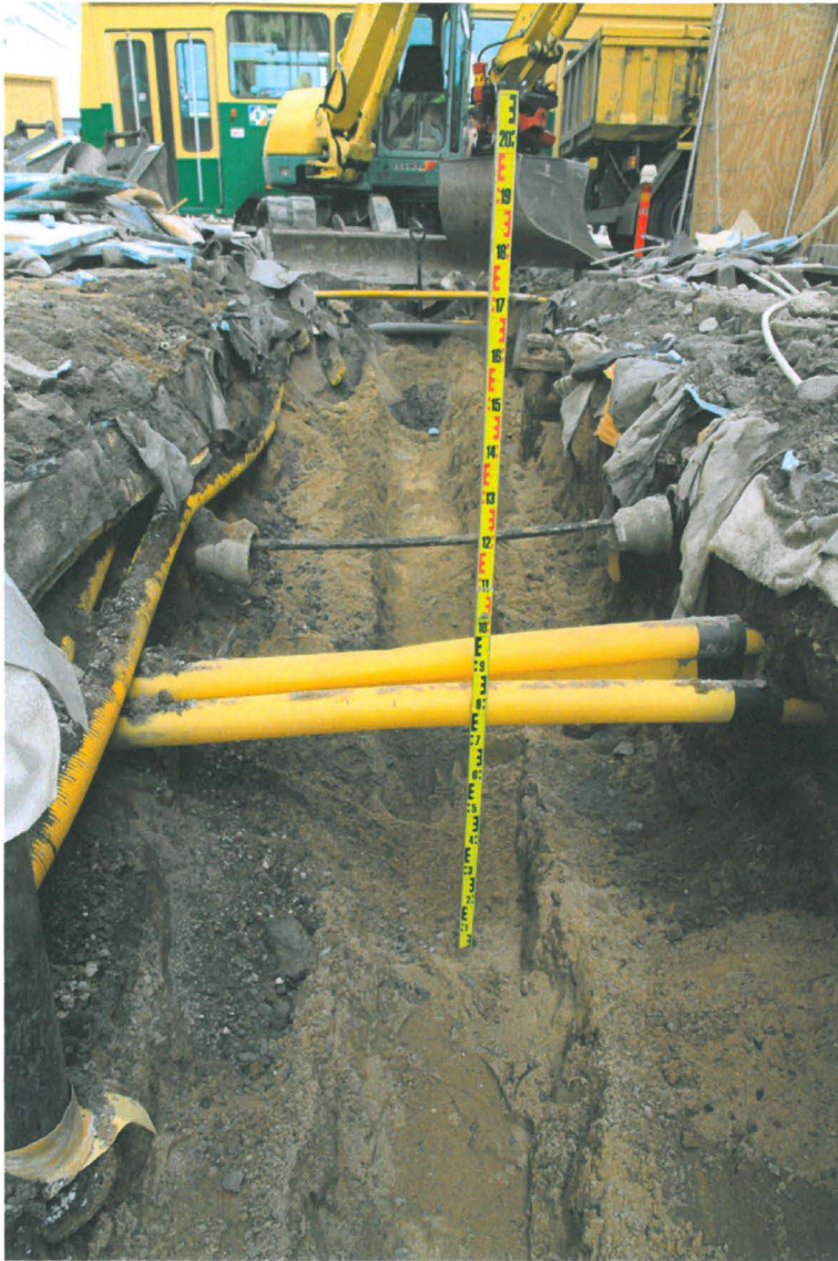
Kuva 207. Sunnin putkikaivanto. Sofiankadun pohjoispäähän kaivannon pohjalle on kaivettu kapeampi oja. Kuvaussuunta N. 9.7.2010.
