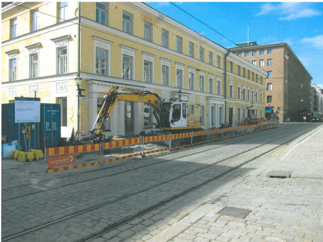
Kuva 210. Aleksanterinkadun jalkakäytävä. Jalkakäytävän laajennuksen ja sen alaisen kunnallistekniikan kunnostamisen työmaa Sunnin edessä toukokuun alussa. Kuvaussuunta SWW. 2.5.2011.
