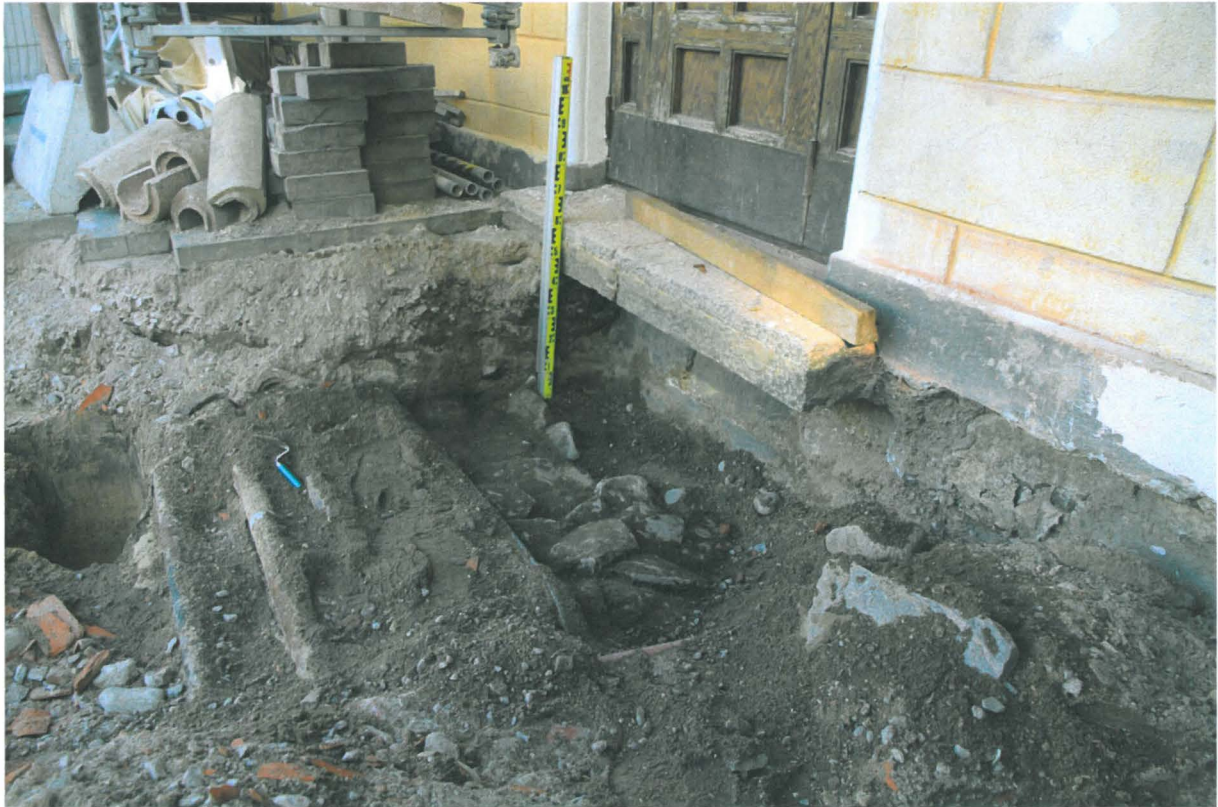
Kuva 173. Kiseleffin putkikaivanto. Kaivanto Kiseleffin jalkakäytävän kohdalla. Kaapeleiden ja rakennuksen välissä on noin 50 cm leveä kivikerros, jotka liittyvät Kiseleffin pohjoisseinän perustuksiin. Kuvaussuunta SEE. 31.8.2010.
