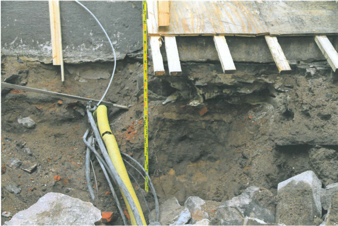
Kuva 162. Sunnin piha. Pihan koilliskulma portaiden alapuolella. Puhdas hiekka näkyy maaleikkauksen alaosassa. Kuvaussuunta N. 31.3.2010.
