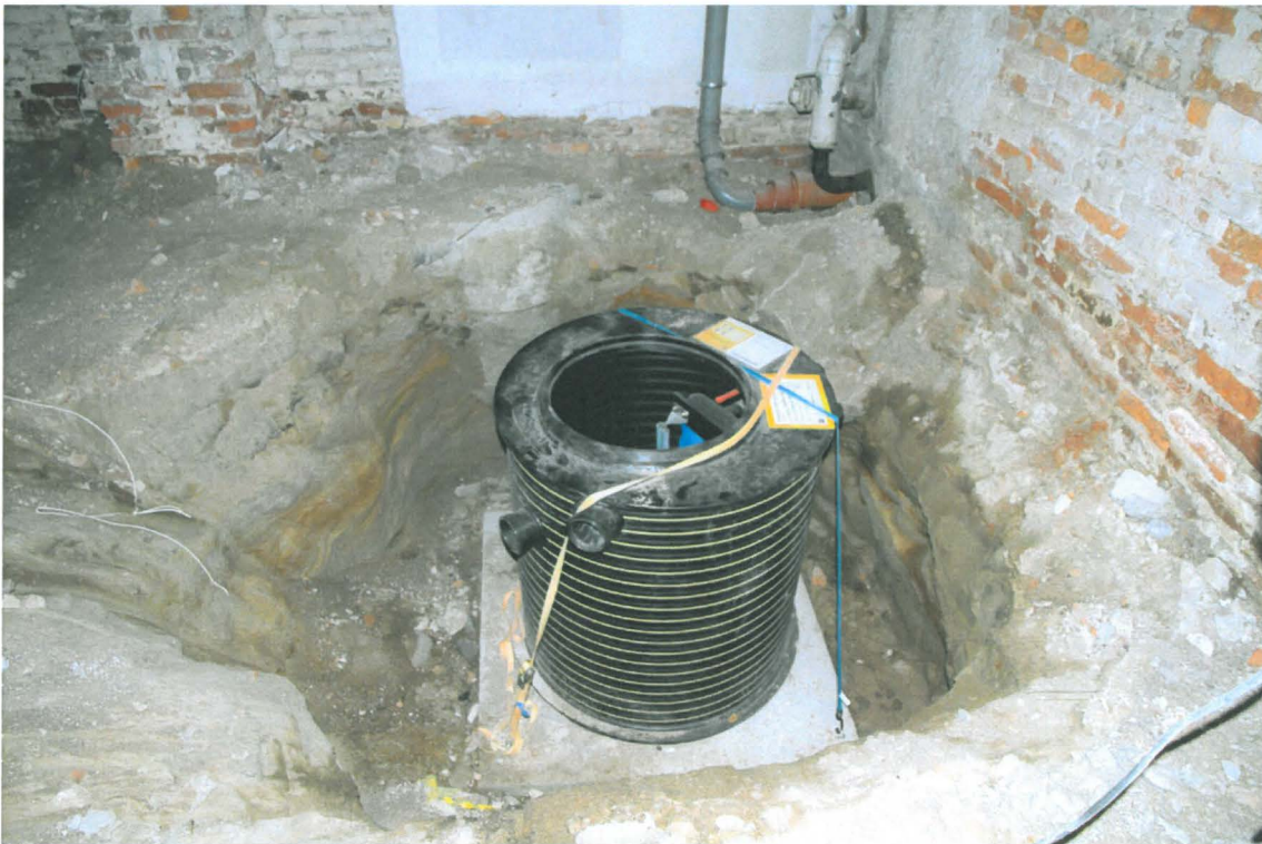
Kuva 121. Kiseleff K016. Uusi kaivo on laitettu kuopan pohjalle. Sen takana näkyy vanha betoninen kaivo. Kuvaussuunta S. 25.5.2010.
