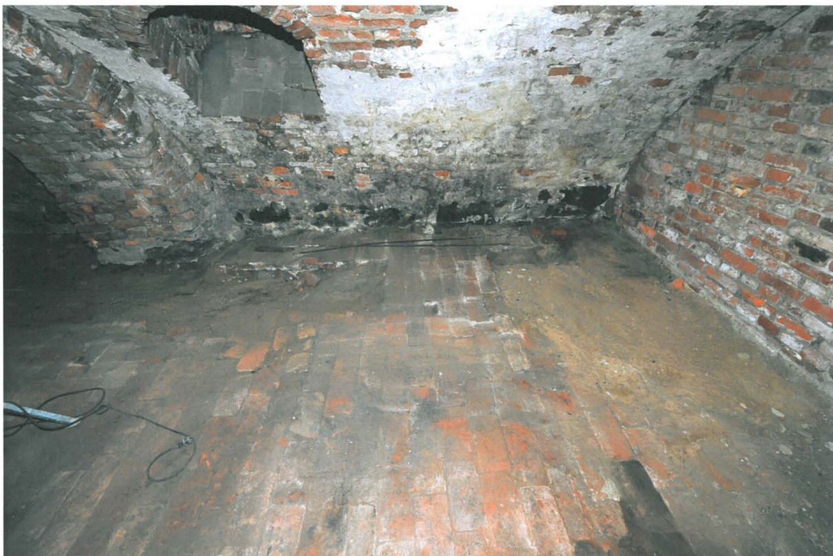
Kuva 33. Sunn S013-014. S014:n itäseinän vierestä puuttui tiililattia kuten myös S013:n tulevassa kapeassa vyöhykkeessä pohjoisseinän kohdalla. Kuvaussuunta N. 22.9.2010.
