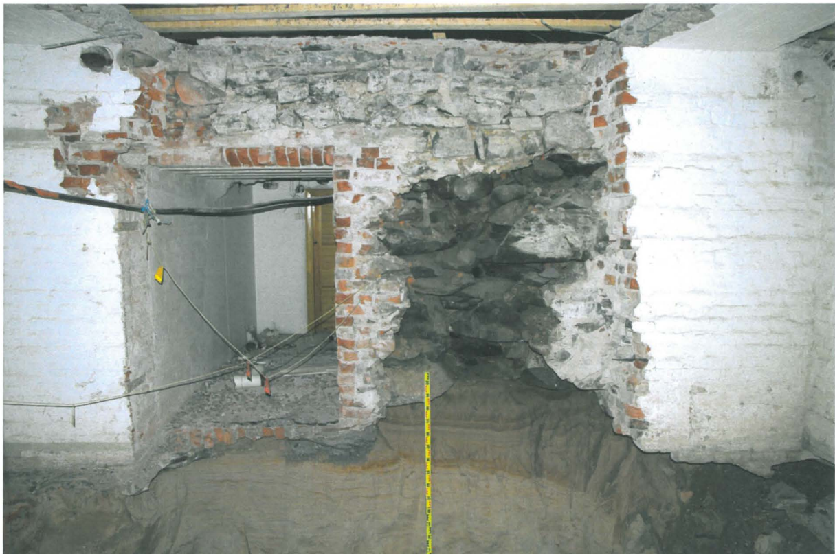
Kuva 103. Kiseleff K057. Hissikuilun pohjoisseinän kohta. Kiseleffin vanhaa kiviseinää on jouduttu purkamaan oviaukon oikealta puolelta. Kuvaussuunta N. 25.5.2010.
