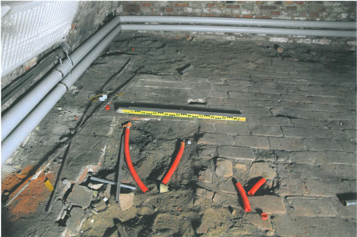
Kuva 37. Sunn S013-014. Koekuoppa 2:n kohta ennen kaivamista. Koekuoppa sijaitsee latan edessä tiililattian vahingoittuneella alueella. Rikotun tiililattian kohdalla latan takana ja vasemmalla puolella on lattian muista tiilistä hiukan eroavat tiilet. Kuvaussuunta E. 8.11.2010.
