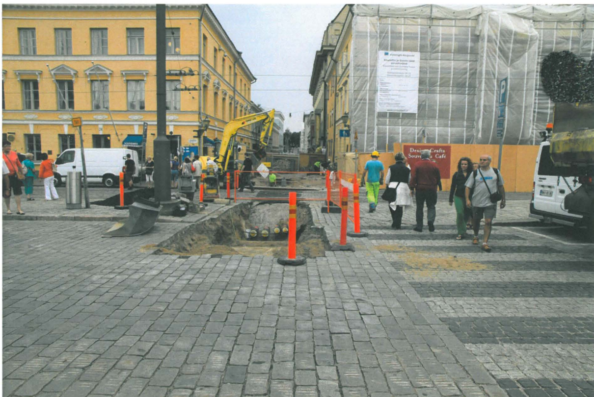
Kuva 189. Sunnin putkikaivanto. Kaivannon pohjoispää. Kohdalle tuli vastaavat kaukolämpö- ja kaukojäähdytysputket ja kaivausmenot kuin Kiseleffin putkikaivannon kohdalla. Kuvaussuunta S. 17.8.2010.
