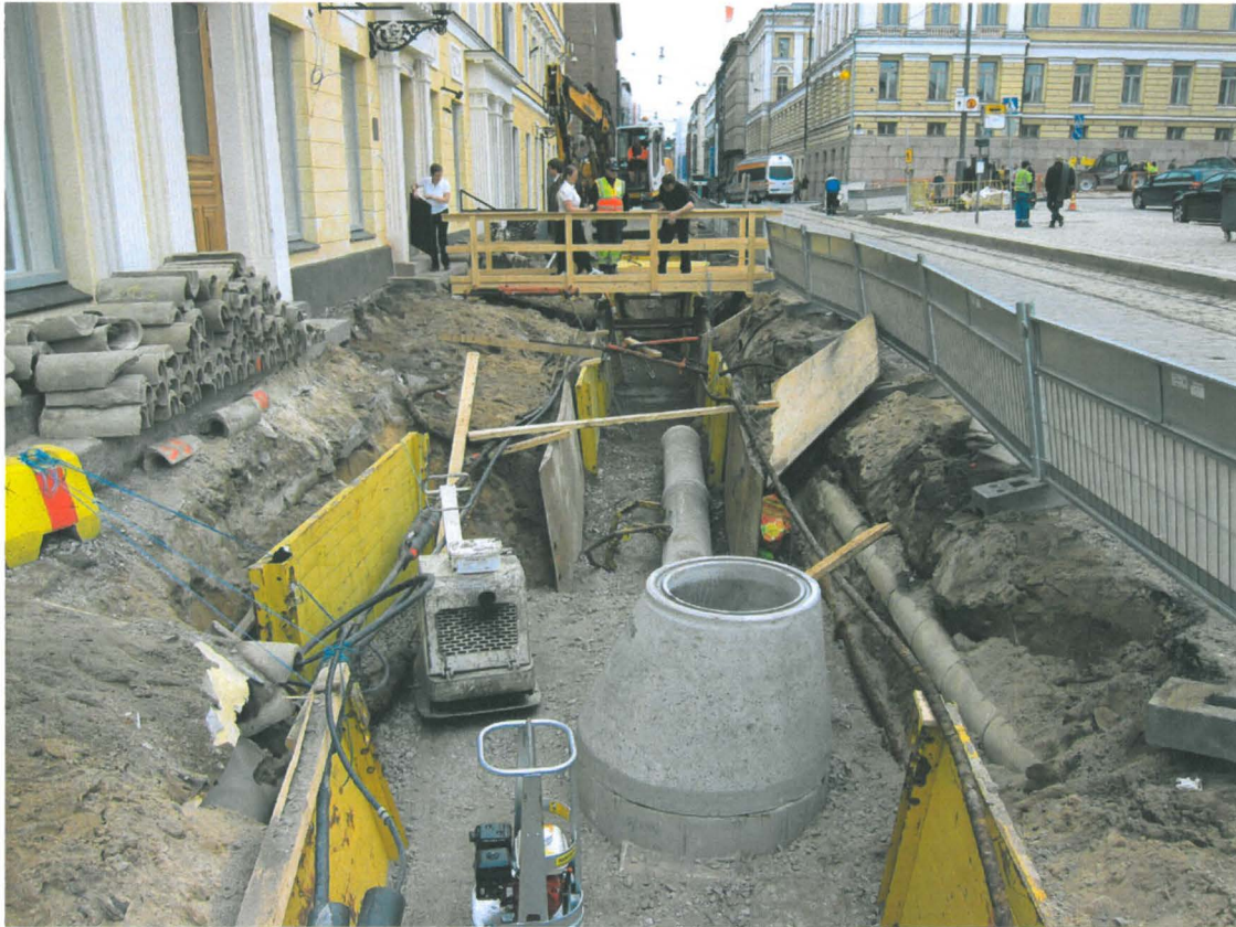
Kuva 213. Aleksanterinkadun jalkakäytävä. Jalkakäytävä on avattu Sunnin kohdalla ja kaivannon pohjalle on asennettu uusi kaivo ja viemäriputki. Kuvaussuunta W. 17.5.2011.
