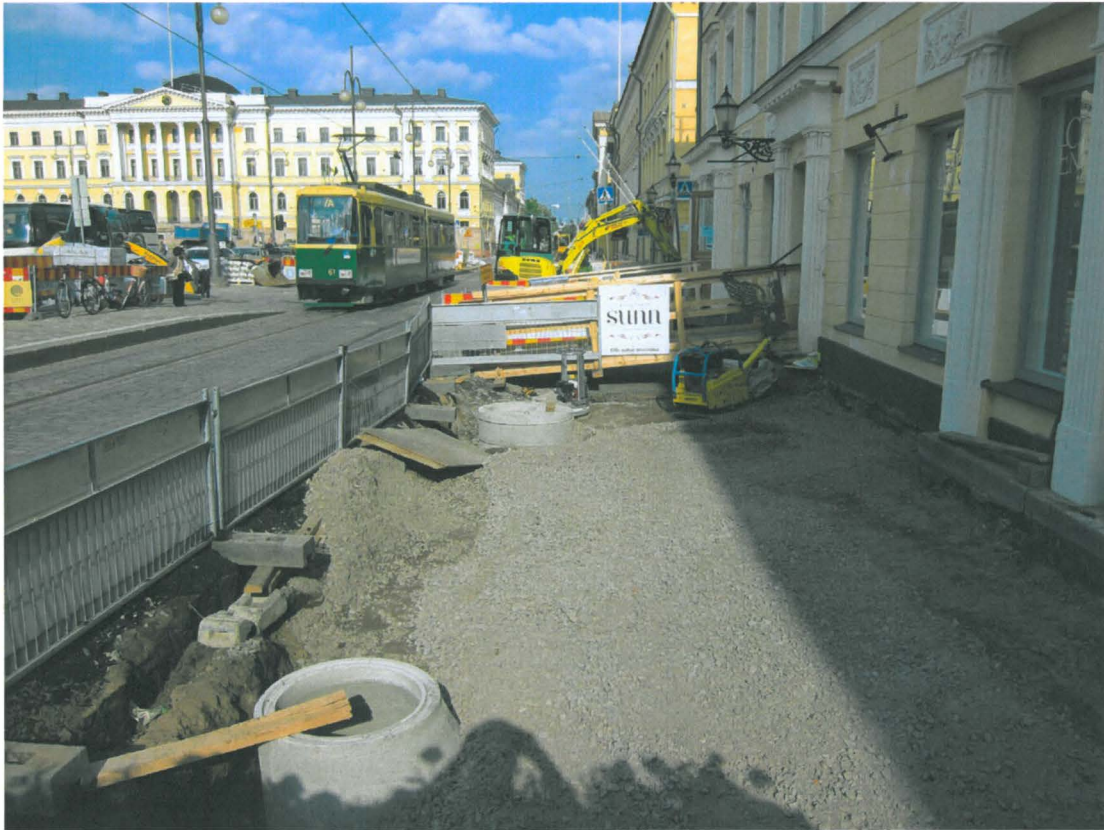
Kuva 223. Aleksanterinkadun jalkakäytävä. Sunnin kohdalla uudet kaapelit, viemärit ja kaivot on peitetty soralla. Kuvaussuunta E. 31.5.2011.
