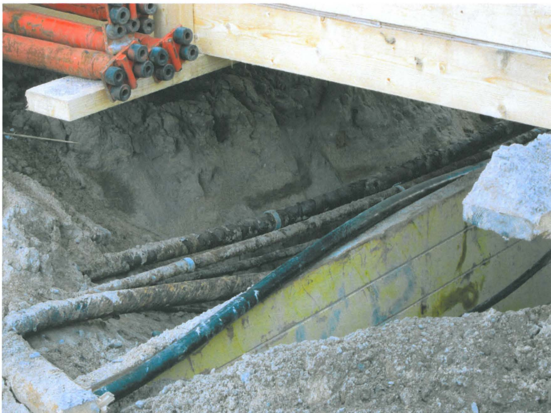
Kuva 216. Aleksanterinkadun jalkakäytävä. Lähikuva edellisestä tilanteesta. Kaapeleiden alta on alkanut heti puhdas hiekka. Kuvaussuunta SW. 20.5.2011.
