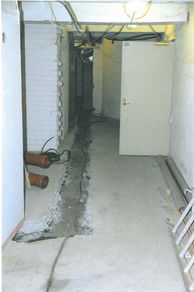
Kuva 122. Kiseleff K047. Käytävän eteläpäässä ennen pyöreätä portaikkoa avattiin lattiaa johtoja/putkia varten. Kuvaussuunta S. 11.6.2010.
