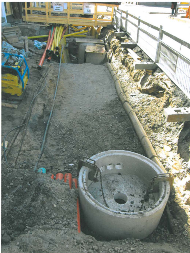
Kuva 222. Aleksanterinkadun jalkakäytävä. Viemärikaivoja ja uusia kaapelisuojujaputkia on asennettu Kiseleffin talon jalkakäytävän kohdalle. Kuvaussuunta W. 26.5.2011.
