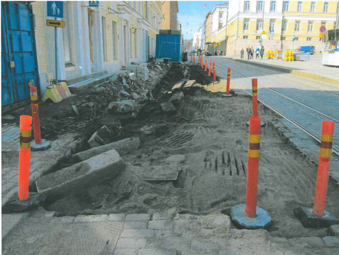
Kuva 211. Aleksanterinkadun jalkakäytävä. Jalkakäytävän laajennus ja sen alaisen kunnallistekniikan kunnostaminen on alkanut Sunnin edessä. Jalkakäytävän reunakivet ja ajoradan kivet on poistettu. Kuvaussuunta W. 18.4.2011.
