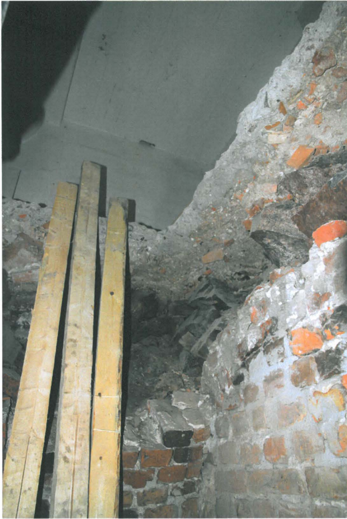
Kuva 57. Sunn S010. Kellarikäytävän itäpäässä tiiliholvi oli rikottu 1. kerroksen betonilattiaan saakka. Kuvaussuunta N. 8.11.2010
