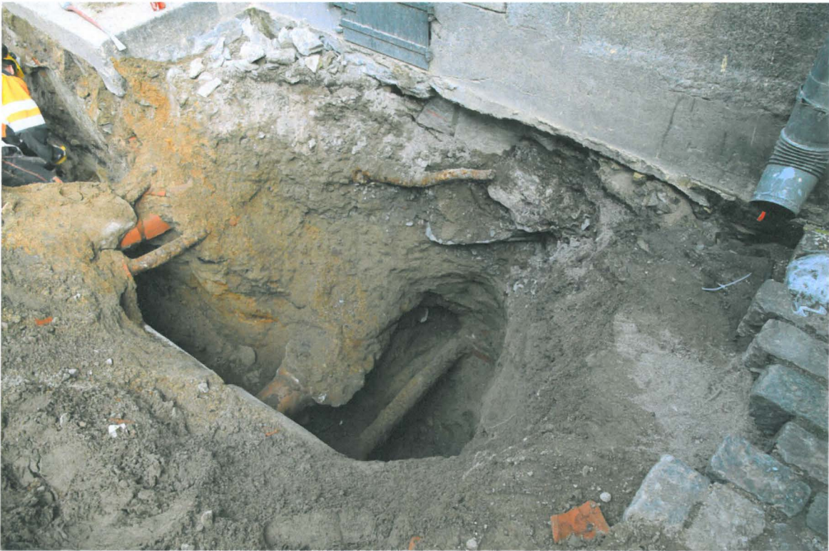
Kuva 239. Unioninkadun jalkakäytävä. Vanhoja putkia, jotka menevät Kiseleffin kellaritilaan K016. Kuvaussuunta NEE. 20.9.2010.
