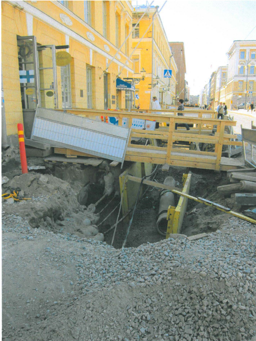
Kuva 230. Aleksanterinkadun jalkakäytävä. Edellinen kohta viemäriputkikaivannon kaivamisen jälkeen. Putki näkyy kaivannon pohjalla. Kuvaussuunta E. 7.6.2011.
