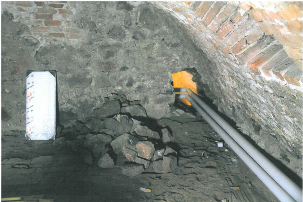
Kuva 53. Sunn S013-014. S013:n länsiseinän läpi oli vedetty putket rikkomalla seinä. Kuvaussuunta W. 8.11.2010.
