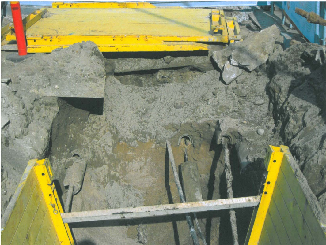
Kuva 228. Aleksanterinkadun jalkakäytävä. Lähikuva edellisestä kohdasta. Vanhojen kaapeleiden alla alkoi heti puhdas pohjahiekka. Kuvaussuunta E. 31.5.2011.
