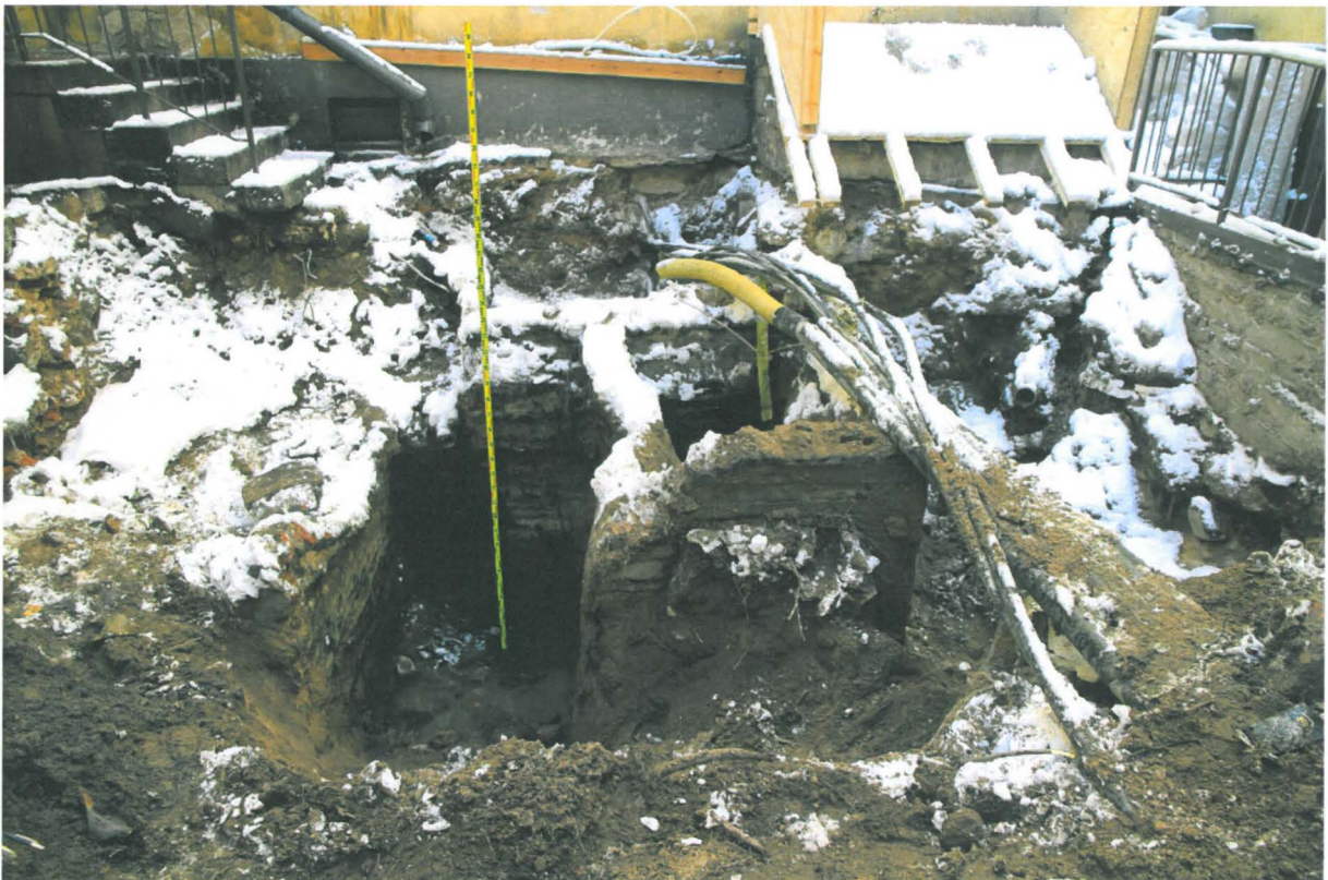
Kuva 153. Sunnin piha. Pihan pohjoisosan keskiosasta tuli esiin kaksi alaosastaan betonista ja yläosastaan tiilistä rakennetta (rasvakaivo/saostuskaivo), jotka olivat molemmat uudehkoja käyttämättömiä rakenteita. Seinät olivat kreosiitin peitossa. Kuvaussuunta N. 22.3.2010.
