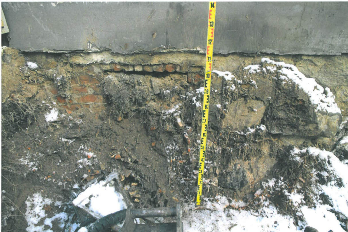
Kuva 161. Sunnin piha. Pihan lounaiskulmassa pihatason alapuolella oli maamassojen takana tiilirakenne (kellariaukko ?). Kuvaussuunta W. 22.3.2010.
