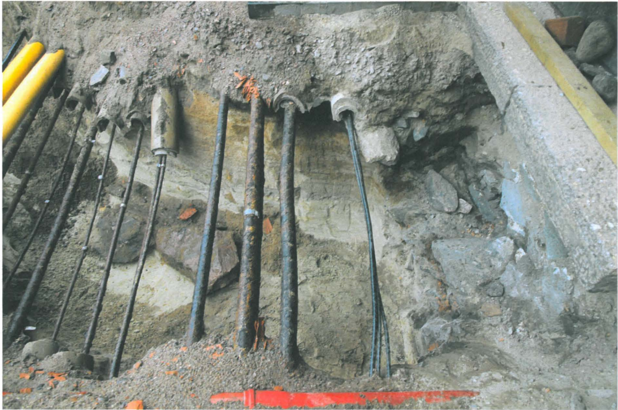
Kuva 179. Kiseleffin putkikaivanto. Kiseleffin jalkakäytävän kaivannon itäprofiili. Kaapeleiden alla on heti puhdas pohjahiekka. Kuvaussuunta E. 3.9.2010.
