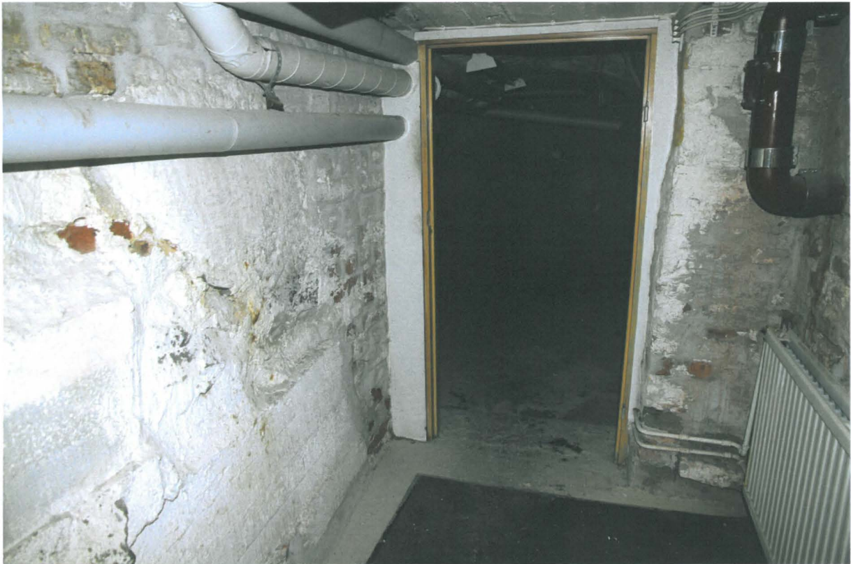
Kuva 66. Sunn S019. Välitila edellisen kohdan ja kellaritila S018 välissä. Tämän poikki tehtiin uusi käytävä. Kuvaussuunta S. 25.5.2010.
