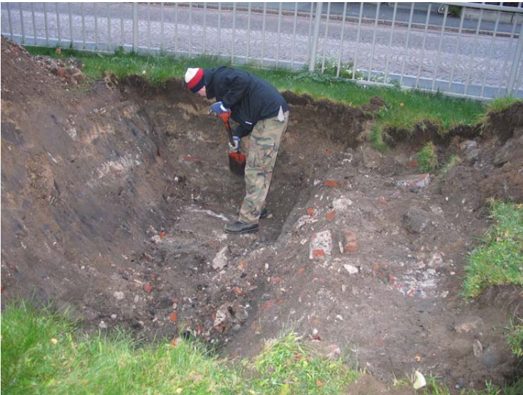
Kuva 5. A. Krapu toteaa kellarin seinän betoniksi (17.10.2005, K. Jylkkä)
