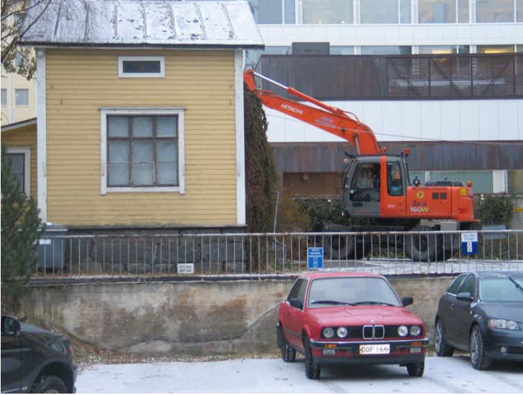
Kuva 18. Koneen pääsy tontin 2 kaivausalueille oli vaikeaa mm. pihan poikki roikkuneen omakotitalolle tulleen sähkökaapelin vuoksi. (28.10.2005, K. Jylkkä)
