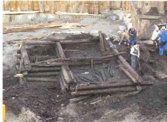
Digitaalinen kuva nro 14. Työkuva. R19:sta kaivetaan. Kuvattu luoteeseen. Kuvaaja: Terhi Taipaleenmäki, MV/RHO.
