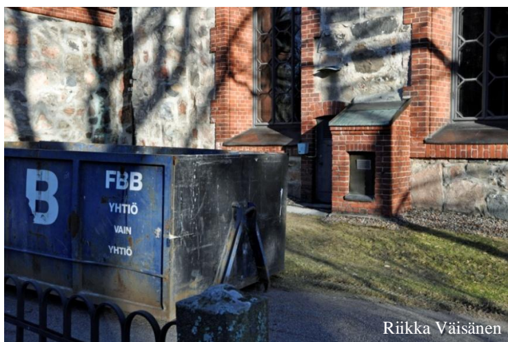
Kuva 3. Kellarin ulko-oven eteen tuotu lava kaivausten aikana tulevia maamassoja ja muita purkujätteitä varten. Kuva otettu luoteeseen.
