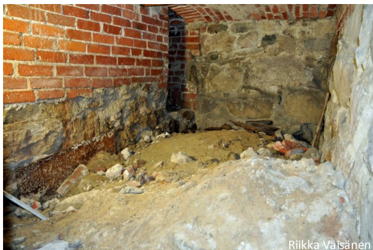
Kuva 1. Pyhän Laurin kirkon kellarin maamassoilla täytetty huonetila ennen kaivausten aloittamista. Kuva otettu länteen.
