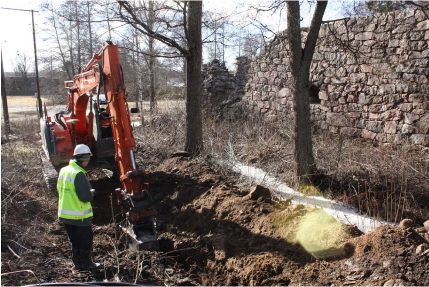
AKDG 3701:23. Kumpareen etelälaidalle kaivetaan ojaa ja sen itälaidan sijainti mitataan GPS:llä, pohjoisesta. Kuvaaja: Petro Pesonen.
