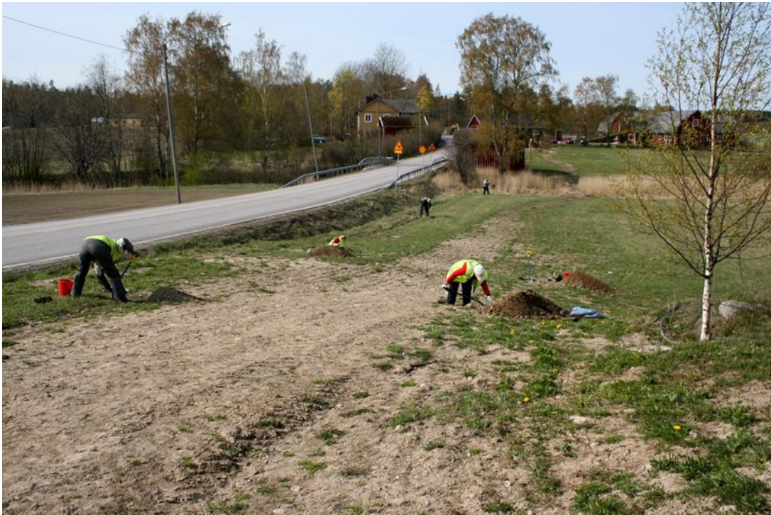
Kuva 8. Koekuoppia kaivettiin tiesuunnitelma-alueelle tuoreen viemärikaivannon molemmin puolin Haapajärven vanhan kirkon paikan säilyneiden osien selvittämiseksi. Kuvattu etelään. Kuva: Satu Koivisto/ARKE (AKDG3703:5).
