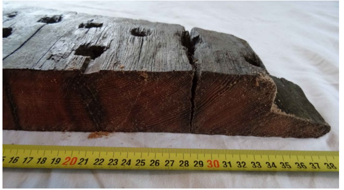
Kuva 5. Lähikuva sahatusta pinnasta, limistä ja ulkopinnasta. Rautanaulan reiät näkyvät ulkopinnalla hyvin. Naulojen kannat ovat ilmeisesti olleet neliskanttisia. Reiät ovat läpimitaltaan noin 1 cm:n suuruisia. Reikien ympärillä on kellertäviä kohoumia, jotka johtuvat raudan korrodoitumisesta merivedessä ja tunkeutumisesta puun sisään.
