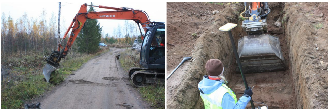
AKDG3880: 5 ja 9. Koeoja 1 kaivettiin Mestarmäentien poikki. Oikealla apulaistutkija Tuija Väisänen valvoo kaivinkonetta. Kuvattu lännestä. Kuvat Esa Mikkola, Arkeologiset kenttäpalvelut 14.10.2014
