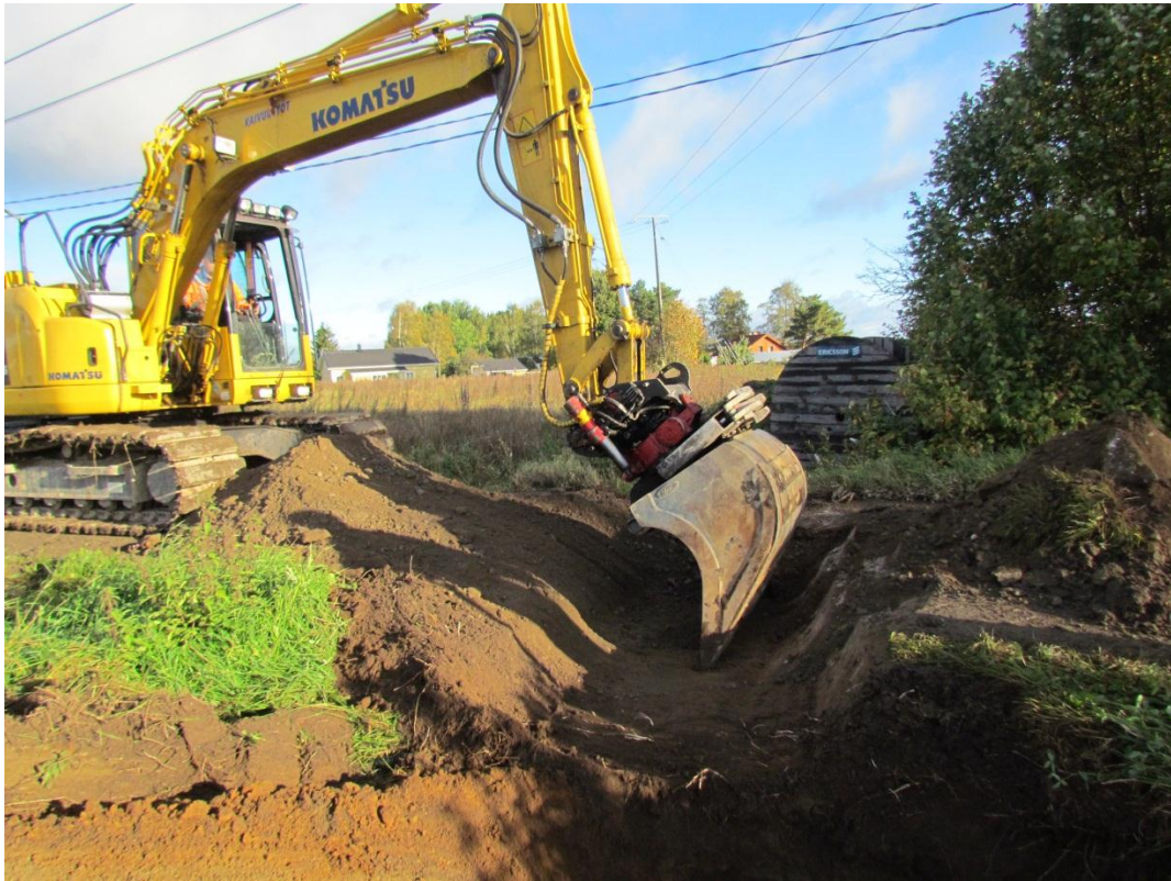
kuva 9. Kaivinkone kaivamassa Pappilantien poikki kulkevaa maakaapelilinjaa. Kuvattu etelästä. (Pälkäne Tiililä, maakaapelointityön arkeologinen valvonta 2012:8)
