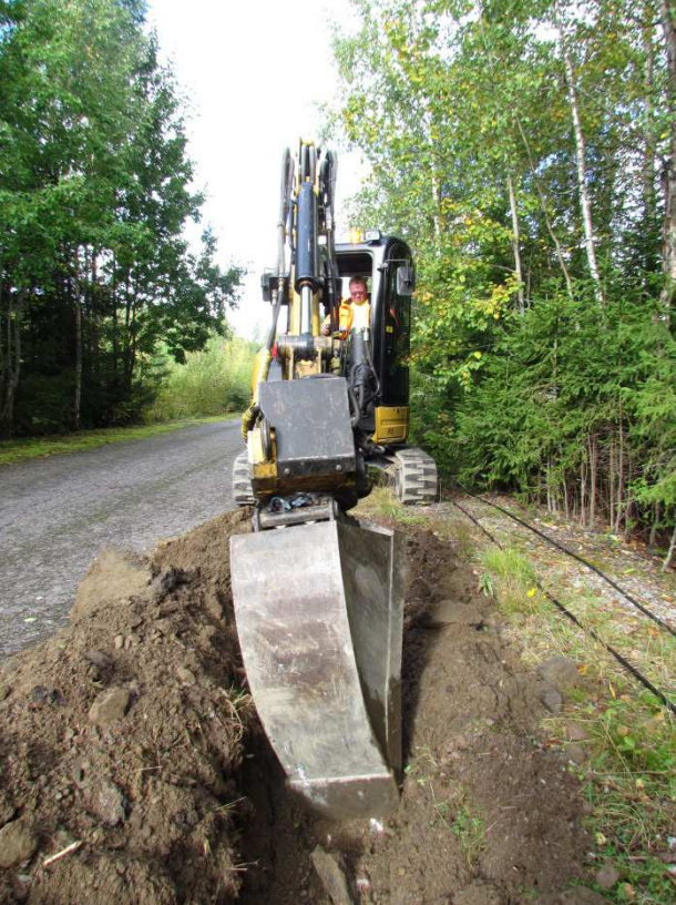
kuva 5. Maakaapeliuraa kaivetaan. Asennettavat kaapelit kuvassa maassa koneen oikealla puolella. (Tampere, Lintukalliontien arkeologinen valvonta 2012:1)
