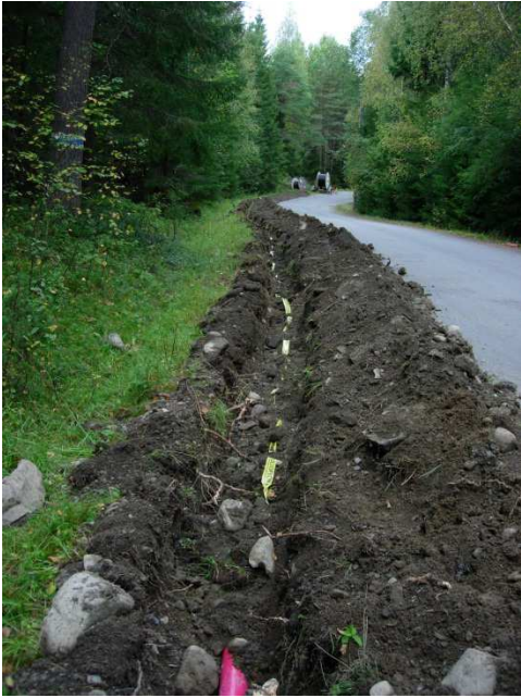
kuva 6. Maakaapeli asennettuna ja esipeitettynä valvotulla linjanosalla A. Kuvattu idästä. (Tampere, Lintukalliontien arkeologinen valvonta 2012:2)
