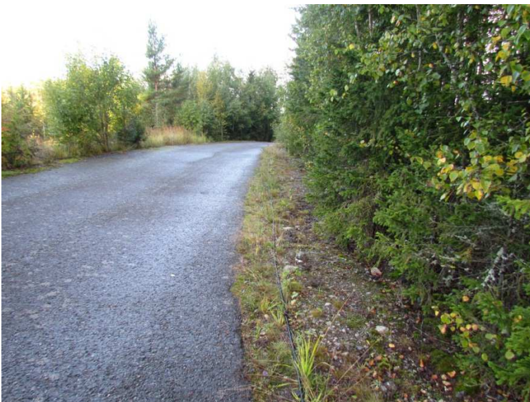
kuva 10. Linjanosa C:llä kaapeli kaivettiin aivan asfaltoidun tienosan viereen, kohtaan jossa kaapelit kuvassa ovat. Kuvattu idästä. (Tampere, Lintukalliontien arkeologinen valvonta 2012:6)
