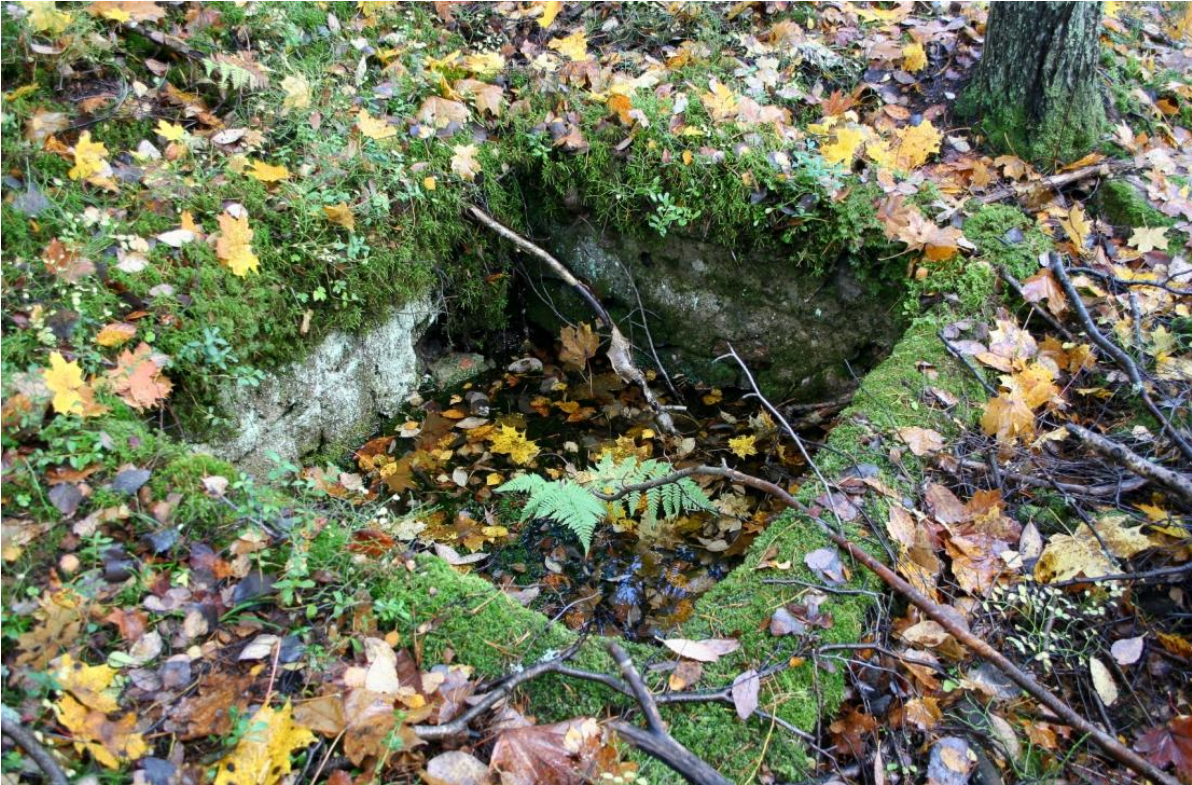
Kuva 12. Hajotettu betonirakenne, jossa on sementti- ja tiilirakennetta. Kuvattu idästä. Kuva: Satu Koivisto/MV (AKDG2864:1).
