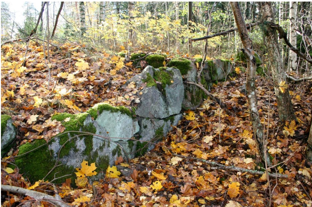
Kuva 4. Luonnonkivistä rakennettu kivijalka johtaa kellariholvin suulle. Kuvattu koillisesta. Kuva: Satu Koivisto/MV (AKDG2883:3).
