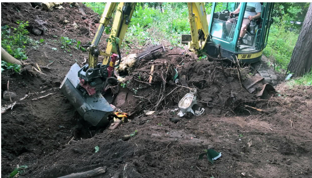
Kuva 3. Päätön kaivinkonekusi kaivaa kylpyhuonekalusteita ym. rompetta yhdyshaudasta. Kuvaussuunta SW. Kuva H. Hämäläinen/HKM 1.7.2016.
